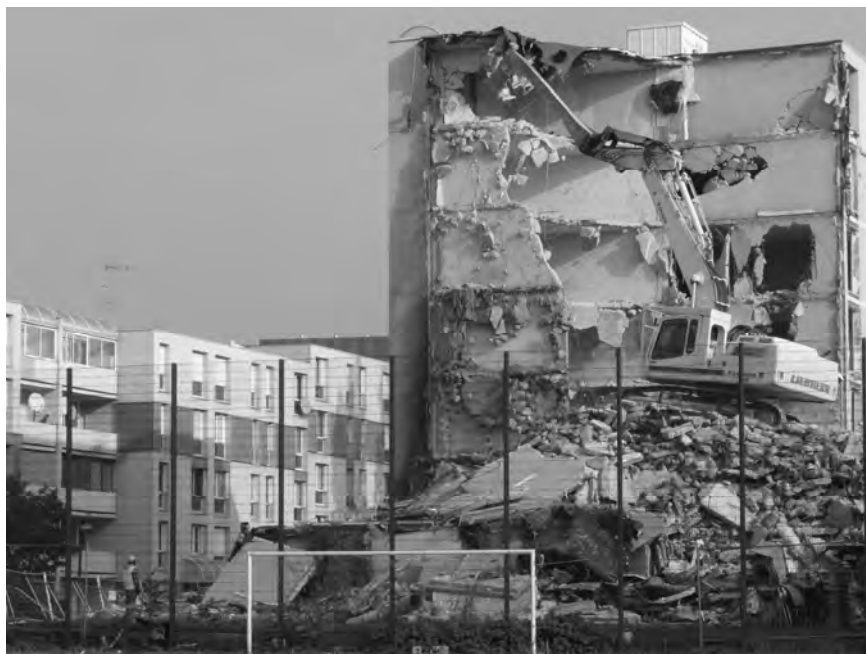
Fig. 4 : Photographie du quartier en cours de destruction, en 2007. Source : Mairie de Cergy.
