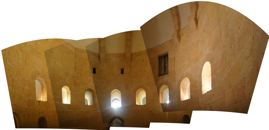
Ilustración 2-14. Ventanas de la estancia superior del edículo central y puerta de acceso a la estancia de retiro. Montaje a partir de fotografías propias.
