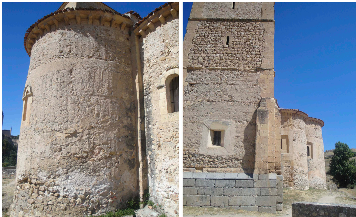
Ilustración 7. Comparativa del método de construcción de ábside principal, de la construcción original, de mampostería, izquierda; y la torre, de construcción posterior, de sillería y con base de granito, derecha.
