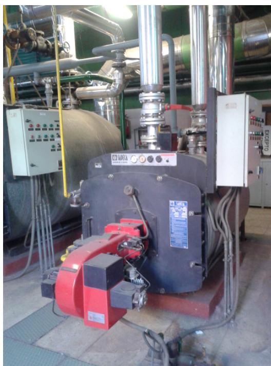
Figura 7.14: Caldera de producción de ACS
