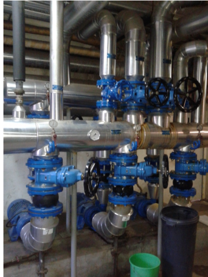
Figura 7.18: Colector general de retorno de frío
