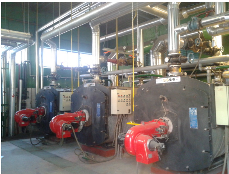
Figura 7.13: Calderas de calefacción
