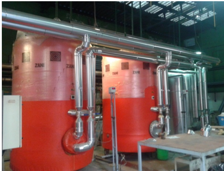
Figura 7.15: Depósitos acumuladores de ACS
