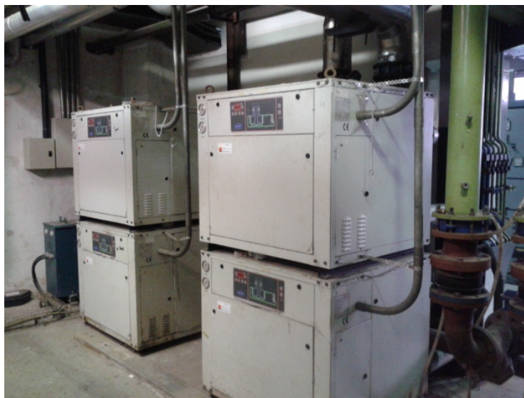
Figura 7.16: Equipos de producción de frío
