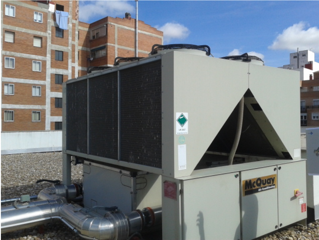
Figura 8.17: Planta enfriadora por agua Centro Salud Canterac
