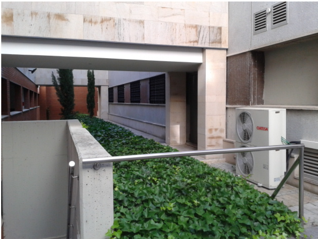
Figura 8.18: Patio interior y bombas de calor
