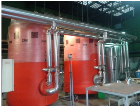
(a) Depósitos de ACS
