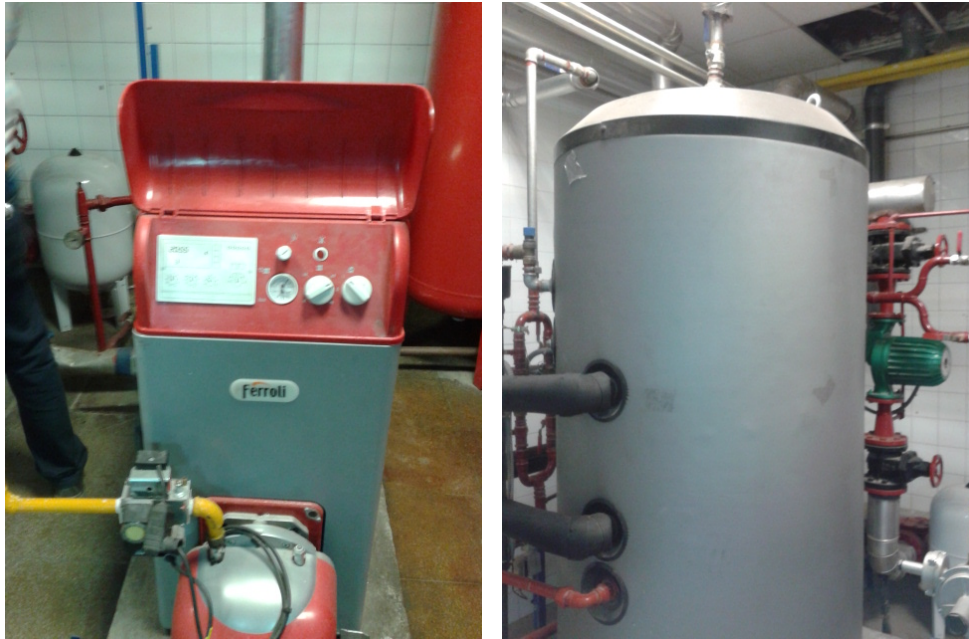
Figura 8.15: Generador y depósito de ACS Centro Especialidades
