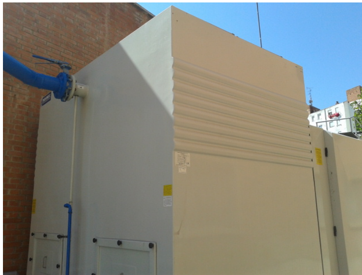
Figura 7.17: Torre de refrigeración
