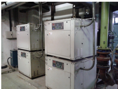
(c) Enfriadoras de condensación por agua
