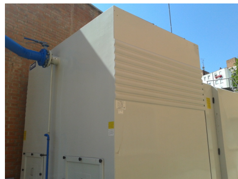
(d) Torre de refrigeración
