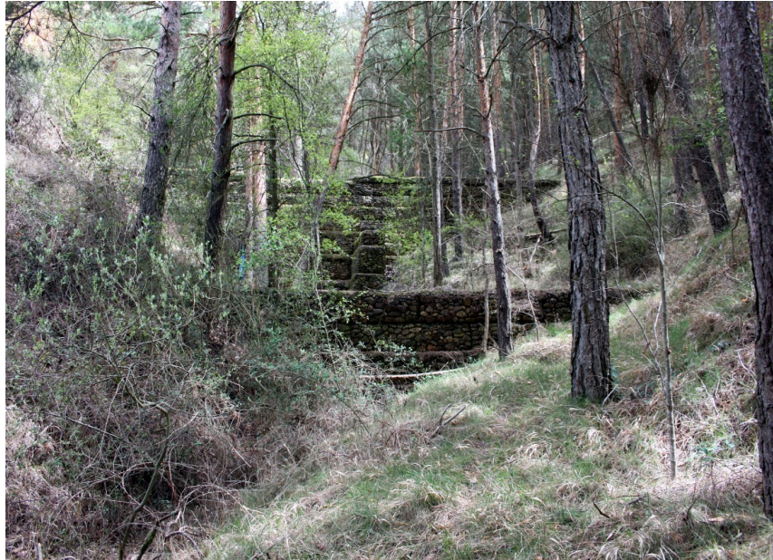
Foto 1. Diques nº 66 y 67 localizados en la cárcava nº 27 (JMB, abril 2012)
