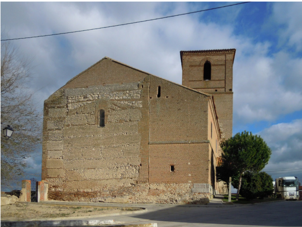
Figura 5.20. Alzado oeste iglesia de San Pelayo, Sinlabajos, AV. Se diferencian las cajas de épocas constructivas distintas. Primitiva silueta a dos aguas, y sobreelevación realizada en mampostería caliza. Contrafuerte medieval con sistema constructivo distinto a los dos utilizados en la nave.
