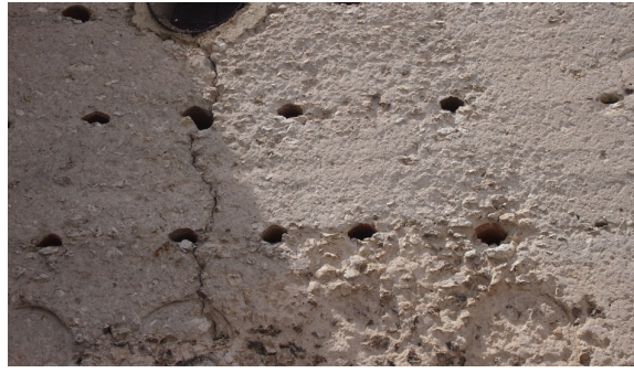
Figura 6.8. Tapia cal y canto con canal realizado con tejas para albergar las agujas. Iglesia de San Andrés, Cuéllar. SG.
