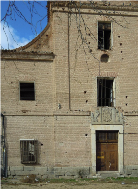
Figura 6.4. Hospital Simón Ruiz, Medina del Campos. VA. Mechinales pertenecientes a los andamios.
