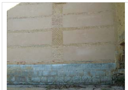
Muro con zócalo de piedra y sistema mixto de ladrillo y tapia
