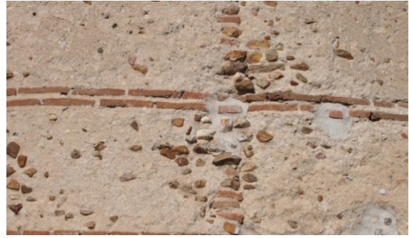
Figura 5.68. Detalle de mechinal donde se aprecia aguja de madera en el interior.
