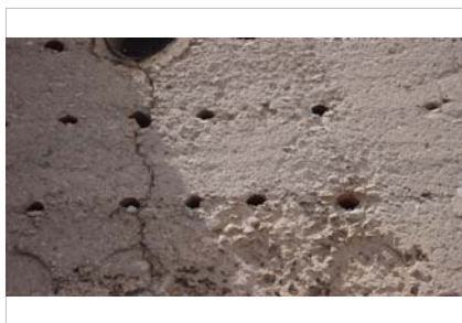
Muro oradado por los mechinales
