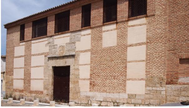
Figura 5.157. Cajón de tierra con verdugada de ladrillo con dos hiladas, mechinal dentro de la verdugada, machón de ladrillo en todo el muro recto.
