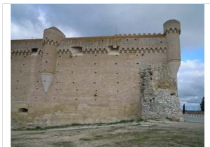
Fachada de ladrillo con oquedades de los mechinales
