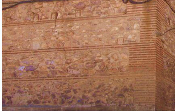
Figura 6.29. Detalle de la iglesia parroquial de Santo Tomás de Aquino, Montejo de Arévalo, Segovia. Ausencia de mechinales.
