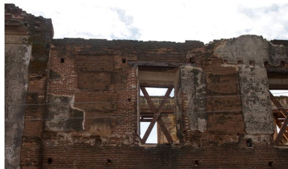
Figura 5.131. Detalle del muro sin los cantos hacia el suroeste del convento de San Agustín Extramuros en Madrigal de las Altas Torres. AV.
