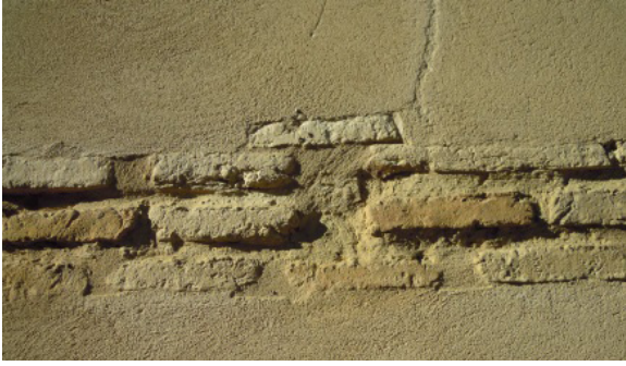
Figura 6.24. En las dos hiladas superiores con elemento de remate. Iglesia de San Miguel de Campos en Villalón de Campos.
