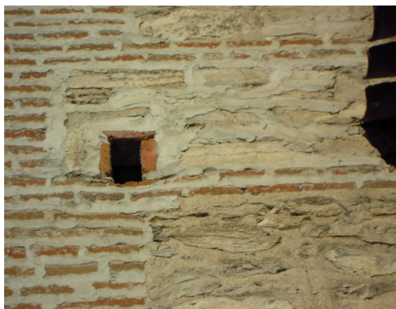
Figura 5.209. Detalle del mechinal donde se albergaban las agujas de los andamios.
