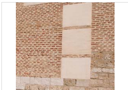
Detalle del muro con los machones rectos, las verdugadas y el zócalo
