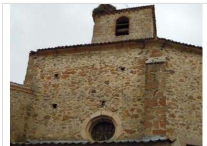
Muro con las trazas de los mechinales
