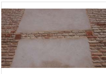
Detalle de los mechinales tapados.
