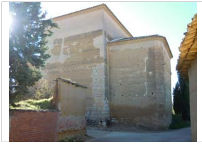
Muro este. Realizado en tapia con refuerzo de sillares en las esquinas.
