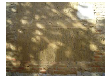
Muro mixto con tapia de tierra y machones y verdugadas de ladrillo
