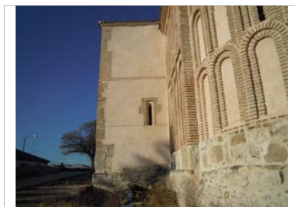
Parte del ábside y muro de la nave con refuerzo de piedra en las esquinas
