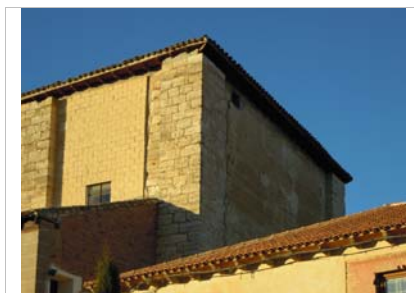
Detalle del muro este, con los machones de sillar y los cajones de tapia.
