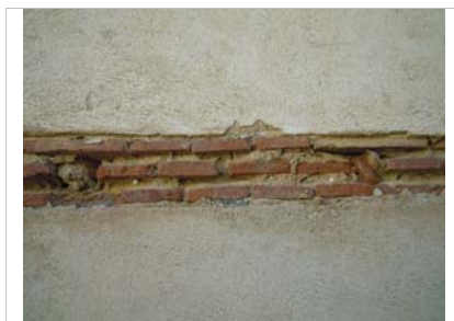
Detalle de los huecos de los mechinales en la verdugada ocultos
