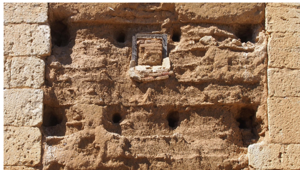
Figura 6.11. Entropaño de tapia de tierra con mechinales sin protección en la iglesia de Villabaruz de Campos.
