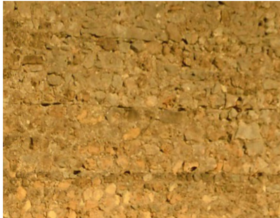
Figura 5.8. Detalle de la tapia de cal y canto de la muralla de Fuentidueña. SG.
