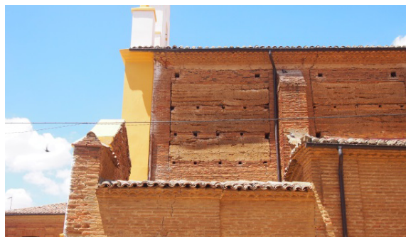
Figura 5.230. Detalle del muro de la nave de la Iglesia de San Juan. Sahagún (LE)
