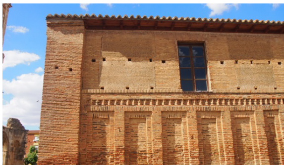
Figura 5.229. Recrecido de los muros de la iglesia de San Tirso en Sahagún (LE) realizados en muro mixto.
