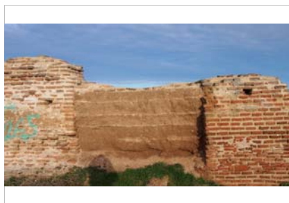
Cajón de tapia de tierra entre machones de ladrillo situado en la cerca
