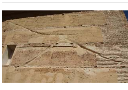
Machones de ladrillo en las esquinas y verdugado el resto del muro.
