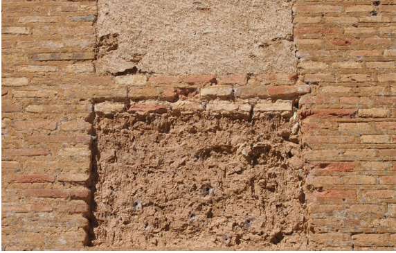
Figura 6.28. Detalle del muro de la fábrica de Harinas de Medina de Rioseco (VA). Ausencia de mechinales.
