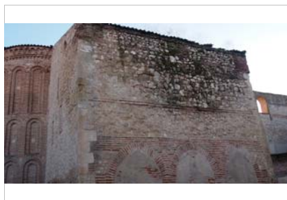
Fachada Sur, detalle de muro verdegado
