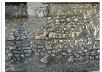
Muro sureste parte inferior de mampostería
