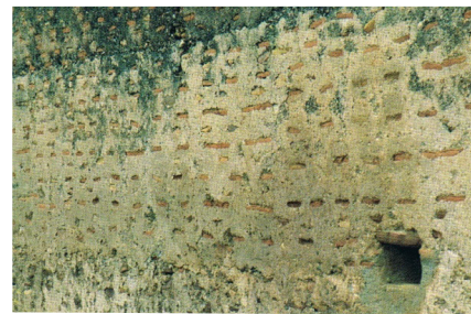
Figura 2.1. Muro de tapia valenciana de Mascarell. Ilustración extraída del libro 'Arquitecturas de tapia'
