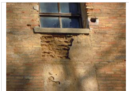
Detalle de los entrepaños de adobe meteorizado con mortero entre las verdugadas
