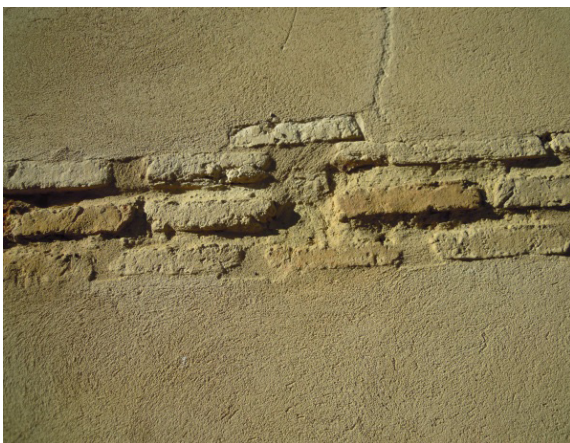
Figura 5.241. Detalle del mechinal en la iglesia de San Miguel en Villalón de Campos (VA).
