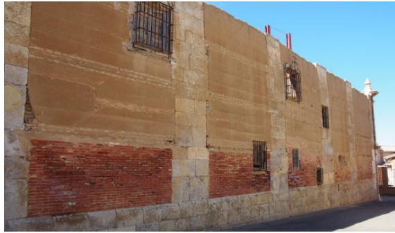
Figura 5.2. Muro con machones y verdugadas en edificio palaciego en Villamartín de Campos (PA).
