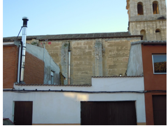
Figura 5.102. Detalle del muro norte de la Iglesia de Santa Cruz en Grijota. PA.
