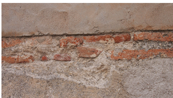
Figura 5.201. Detalle del mechinal oculto en la verdugada de la Torre del Homenaje del castillo palaciego de Narros de Saldueña. AV.
