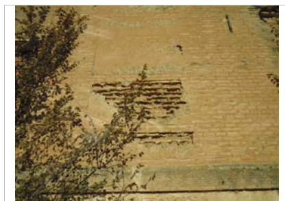
Detalle del deterioro del entrepaño de adobe entre los machones de ladrillo.
