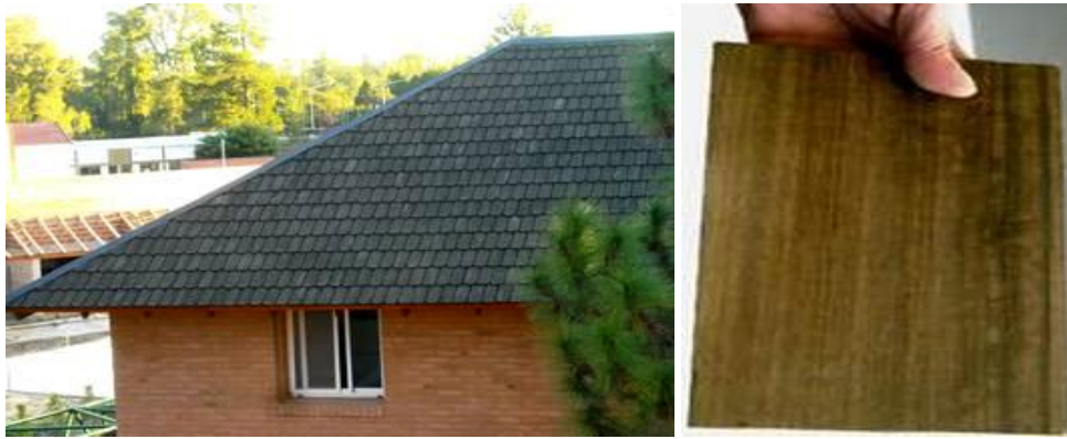
Fig. 6.15. Techo de tejas de eucalipto en Concordia – madera de eucalipto termotratada para preservación
