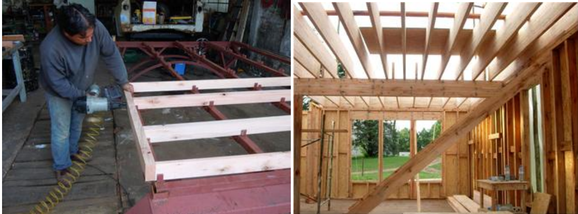
Fig. 6.13 E. grandis : armado de paneles – estructura en casa tipo canadiense en INTA Concordia.
