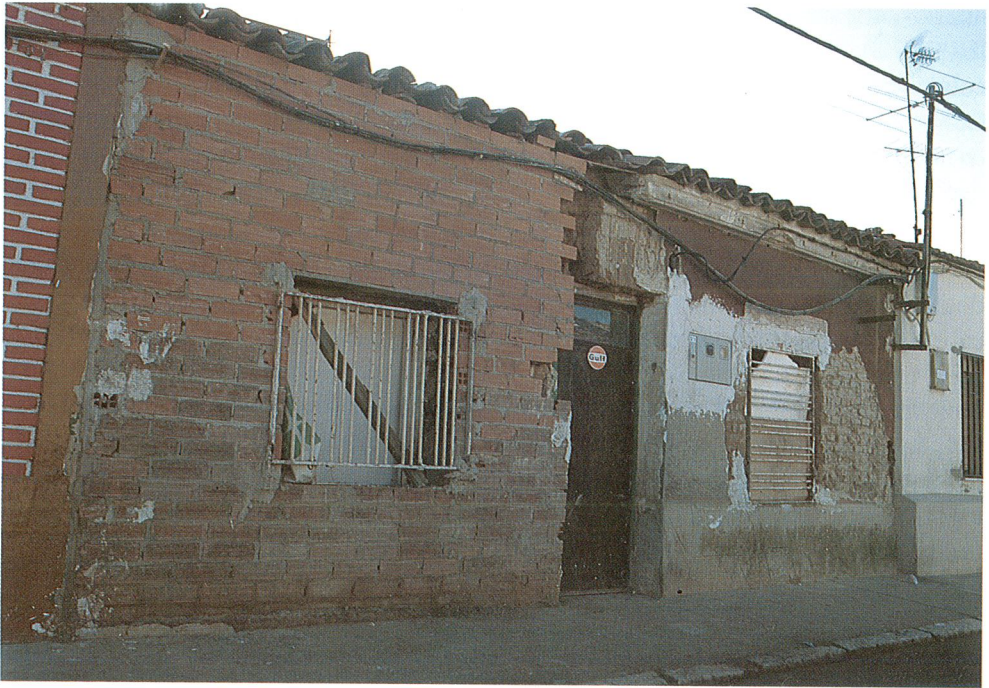
Restos de antiguas casas molineras semiabandonadas en la calle del Bierzo. Un ejemplo del relativamente frecuente abandono de la vivienda por parte de los primitivos ocupantes del Barrio España.
