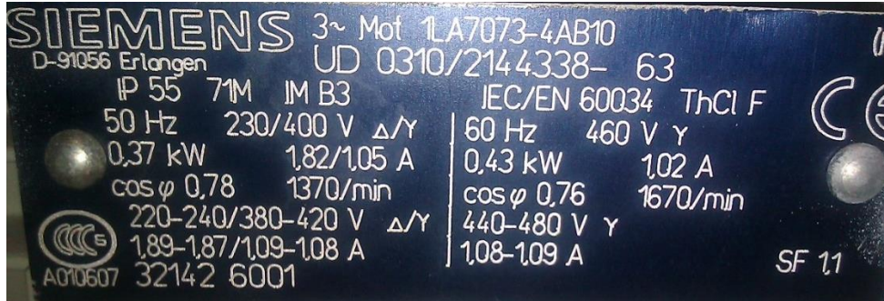
Figura 77. Placa de características del motor
