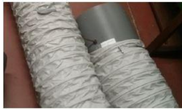
Figura II.9 Conductos de distribución de aire
