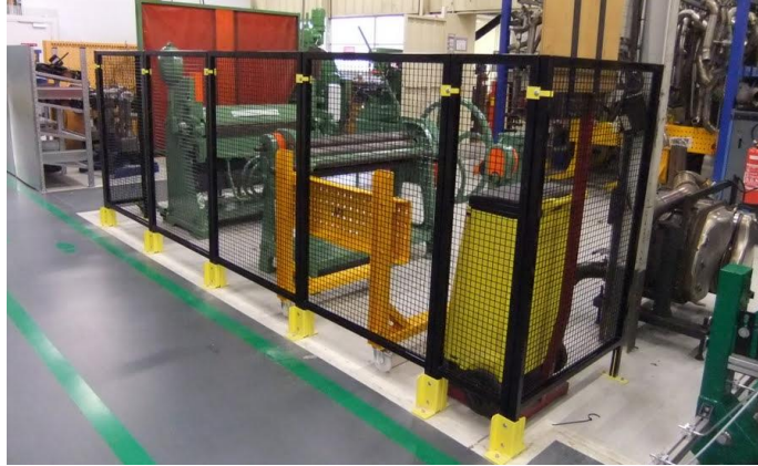
Figura 5.2. Vallado de seguridad
