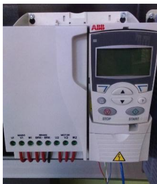
Figura 3.13 Inversor ACS355 de ABB.
