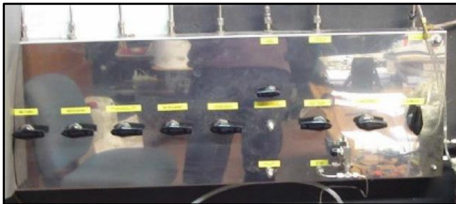
Figura 10: Panel de control de la instalación
