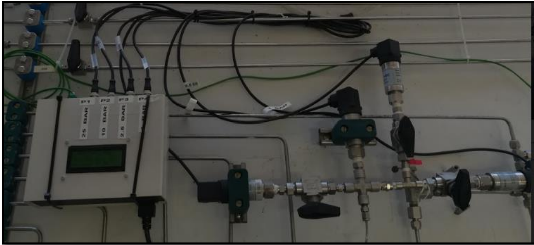
Figura 16: Aspecto de los transductores piezorresistivos (Derecha) en la instalación y su display (izquierda) para lectura
