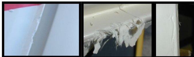
Imagen 2. 33. Defectos de repelado, arrastre y rechupe, respectivamente.
