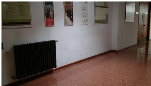
Figuras 29, 30 y 31. Radiadores en la Escuela Técnica Superior de Arquitectura de Valladolid. Hierro fundido, chapa de acero y aluminio.
