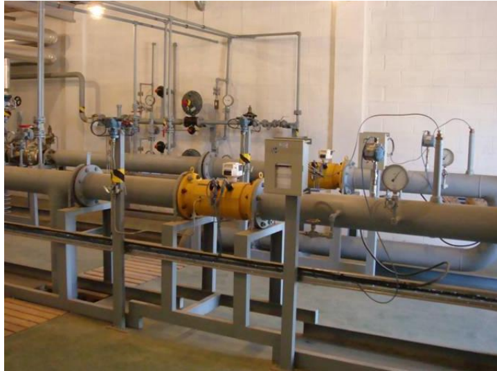
Ilustración 4. Estación de Regulación y Medida
