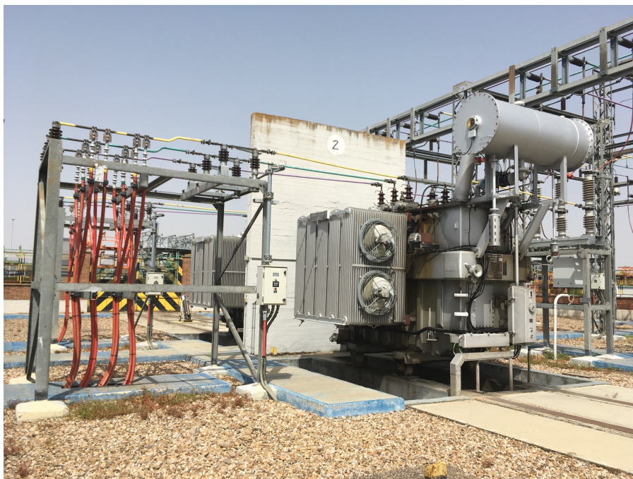
Figura 2.2.6. Salida de los transformadores.
