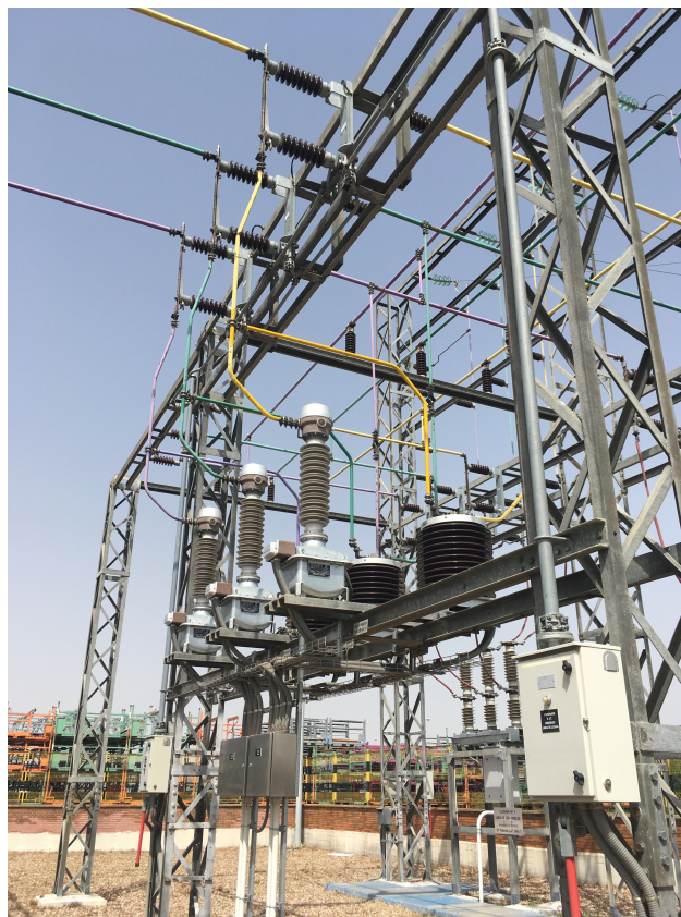
Figura 2.2.4. Transformadores de protección y medida.
