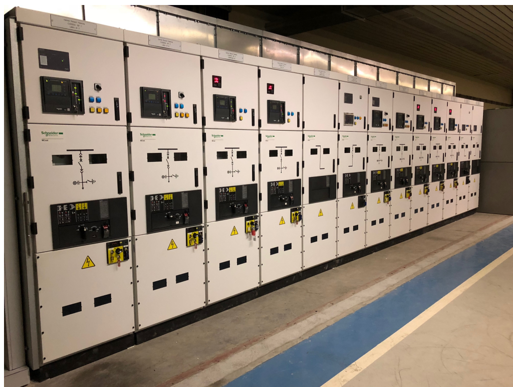
Figura 6.2.1. Centro transformación central térmica.
