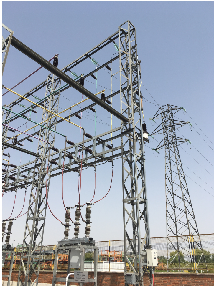
Figura 2.2.1. Llegada de las líneas al parque de 44 kV.
