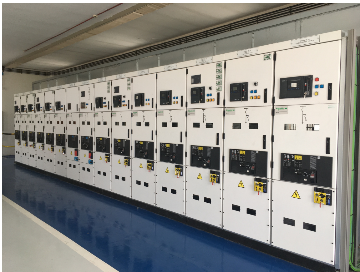
Figura 3.2.1. Cabinas del centro de distribución.
