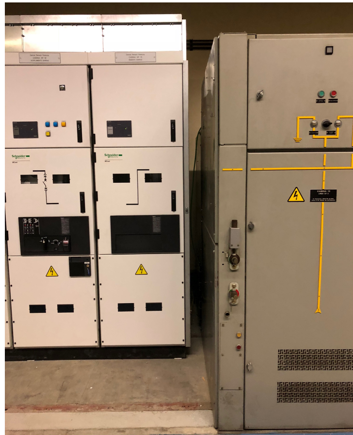
Figura 6.3.1. Cabinas del centro de transformación de la central térmica.
