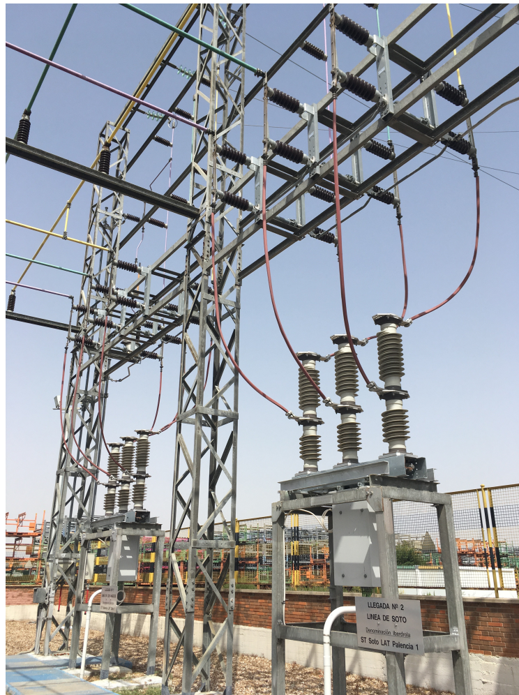
Figura 2.2.3. Juego de protección de Llegada de las líneas.
