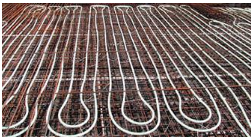
Figura 15. Distribución de tuberías de PEX sobre malla electrosoldada de armado de solera hormigonada en nave industrial.
