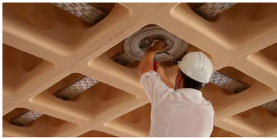
Ilustración 40. Montaje real de la instalación eléctrica.
