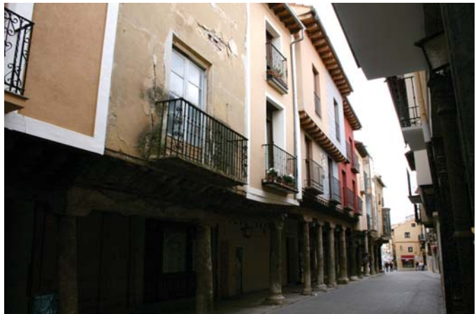
Algunos ejemplos de arquitectura tradicional en ruinas en plena Rúa Elaboración propia
