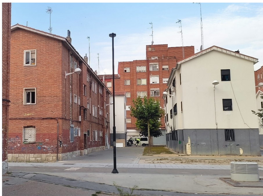
Fig. 44. Comparativa entre el aspecto original de los bloques antiguos de la barriada de 29 de Octubre, a la izquierda de la imagen, y tras su rehabilitación, en la parte derecha. Se aprecian roturas en la parte inferior de la fachada recién rehabilitada.
