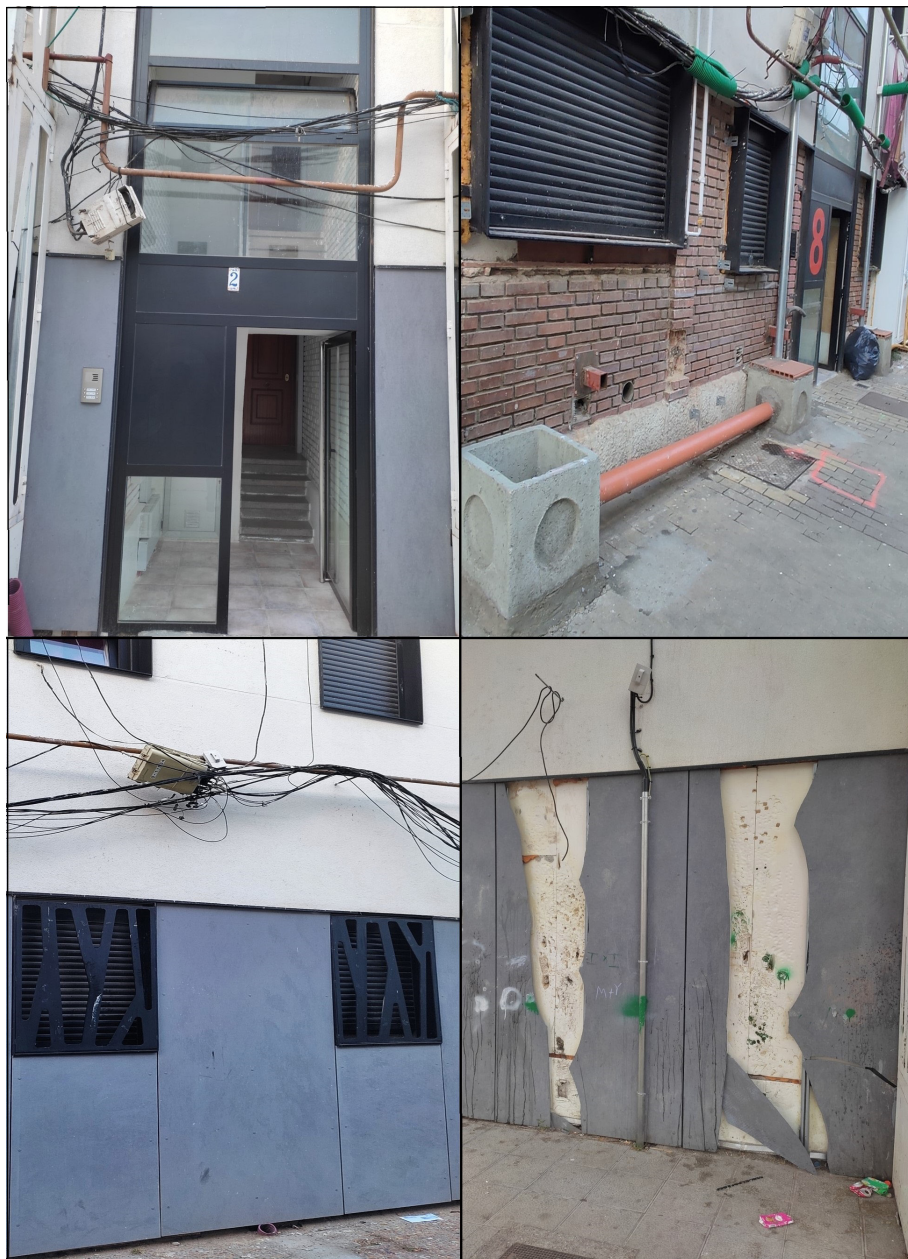
Fig. 45, 46, 47 y 48. Situación de los edificios en los que se ha dado por finalizada la primera fase de rehabilitación en 29 de Octubre, con tuberías y cables vistos al exterior. En la imagen inferior derecha se observa la rotura de las placas cerámicas encargadas de proteger la capa aislante que recubre las fachadas. Fuente: Fotografías del autor, diferentes fechas entre mayo y junio de 2023.
