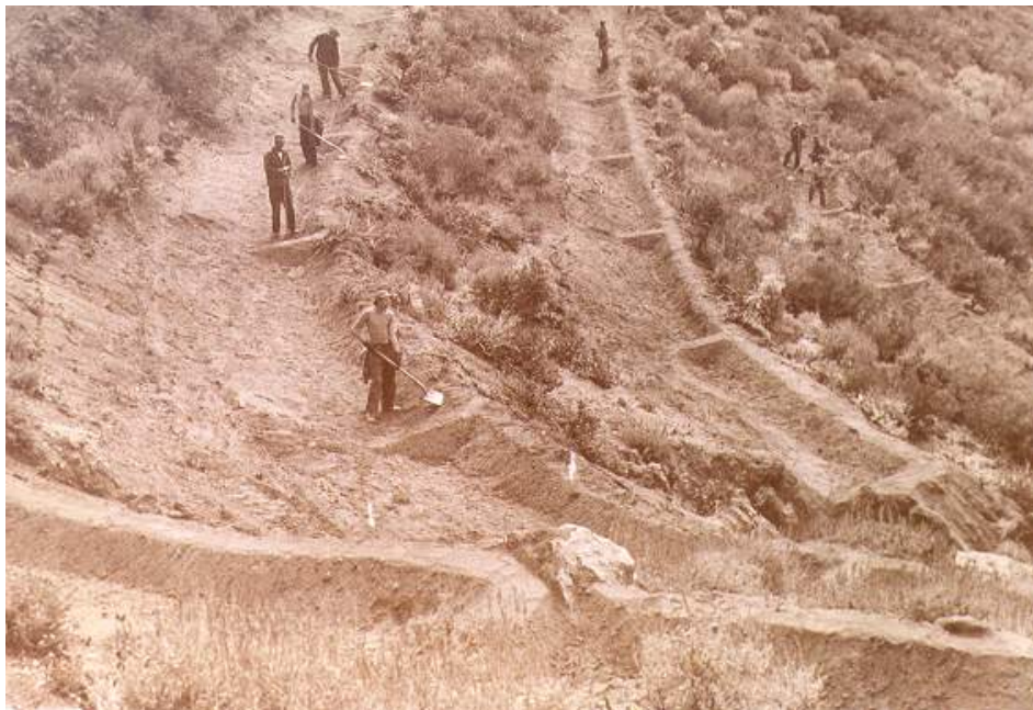
Figura I.10. Construcción de caballones según curvas de nivel cerca de Farmington (Utah, Estados Unidos) por el U.S. Forest Service en 1933 (Ponce, 2003b)
