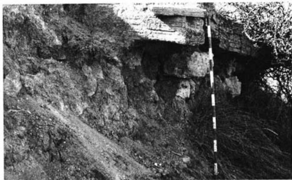
Lámina V, 2. Estado actual, en marzo de 1997, del sector de la muralla reproducido en la lámina anterior. Como se aprecia, buena parte de los sillares, en concreto hasta seis, han caído recientemente.
