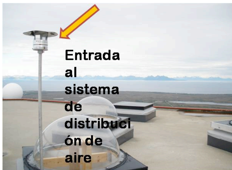
Fig. 21. Entrada al sistema de distribución de aire
