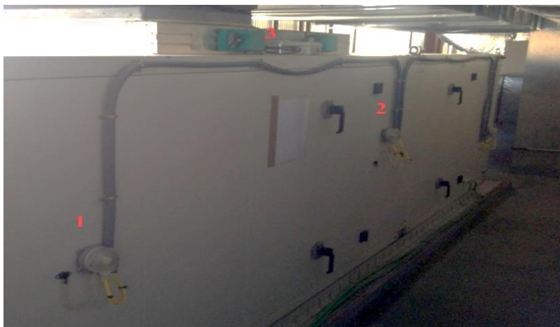
Figura 19. Sondas de presión diferencial in situ (1 y 2)
