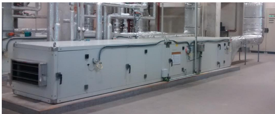
Figura 36. Unidad de tratamiento de aire del hospital
