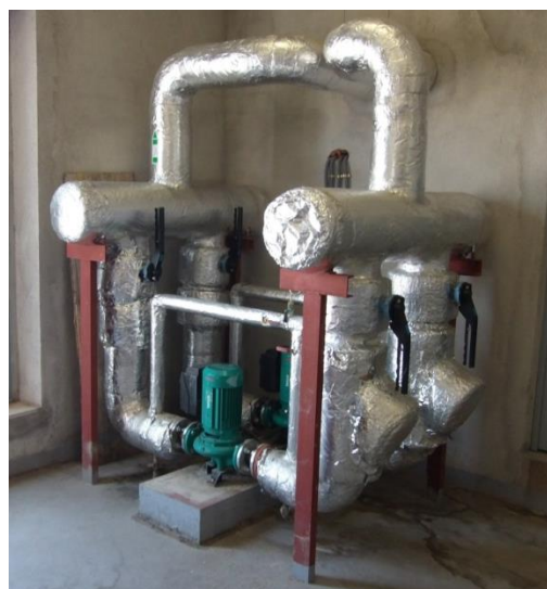
Figura 42. Subcentral de distribución de la instalación.
