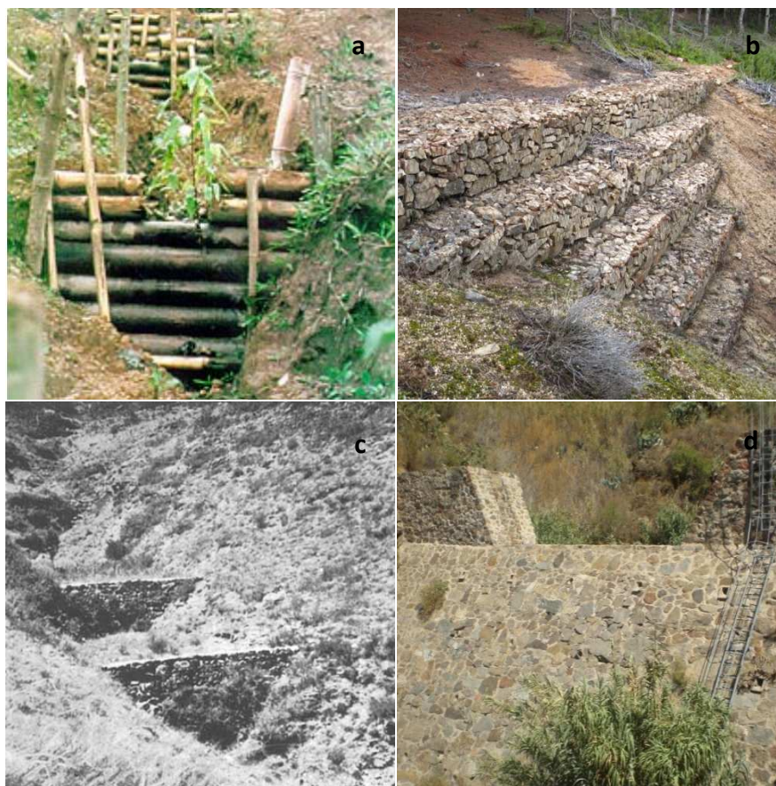
Figura 1.3. a: Trinchos escalonados de guadua ( Guadua angustifolia ) en Palestina (Rivera, 1998). b: Dique de mampostería gavionada en Tórtoles (Ávila). c: Dique de mampostería seca en China (Messines, 1958). d: Dique de mampostería hidráulica en Risco Blanco (Gran Canaria)
