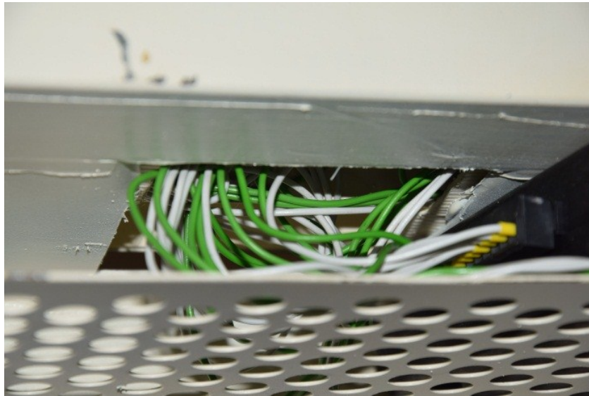
Figura 7.9.- Orificio por el cual el cableado de control de la parte de atrás entra a la bandeja de la tarjeta de adquisición de datos DT9802
