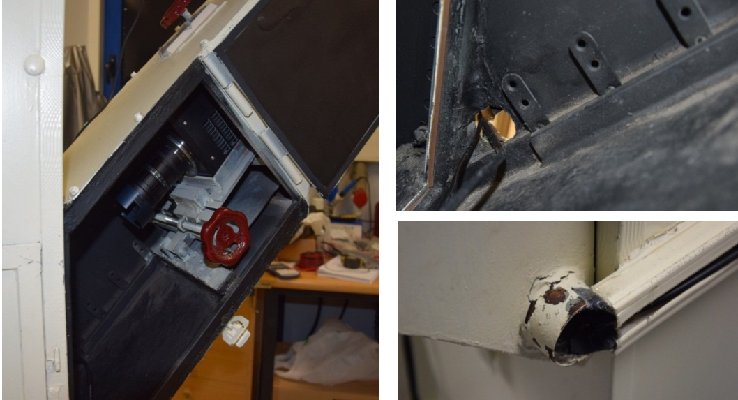
Figura 7.26.- Cámara CCD ubicada en la estructura adicional para las medidas de reflexión (izquierda). Orificio de salida del cableado por la parte interior de la estructura (arriba-derecha). Orificio de salida del cableado por la parte exterior de la estructura (abajo-derecha)
