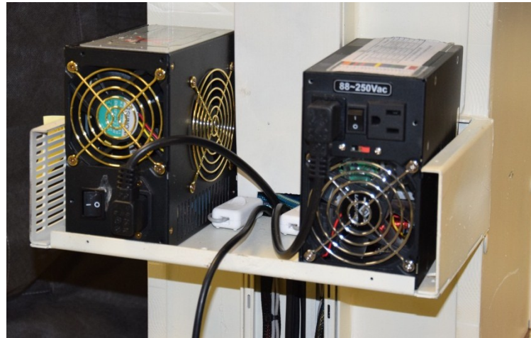
Figura 6.9.- En esta figura apreciamos el soporte donde van situados las fuentes de alimentación y la distribución de las mismas.
