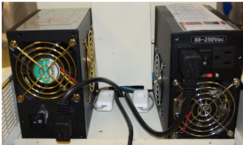
Figura 4.1.- Fuente de alimentación Thermaltake Purepower-560APD (derecha), Fuente de alimentación VANTEC VAN42A (izquierda), ya instaladas en el sistema. También se pueden ver los interruptores adicionales situados entre ambas fuentes utilizados para el control del encendido de las mismas.
