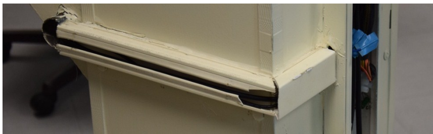
Figura 7.27.- Canaleta utilizada para canalizar el cableado de la estructura adicional hasta la canaleta principal.
