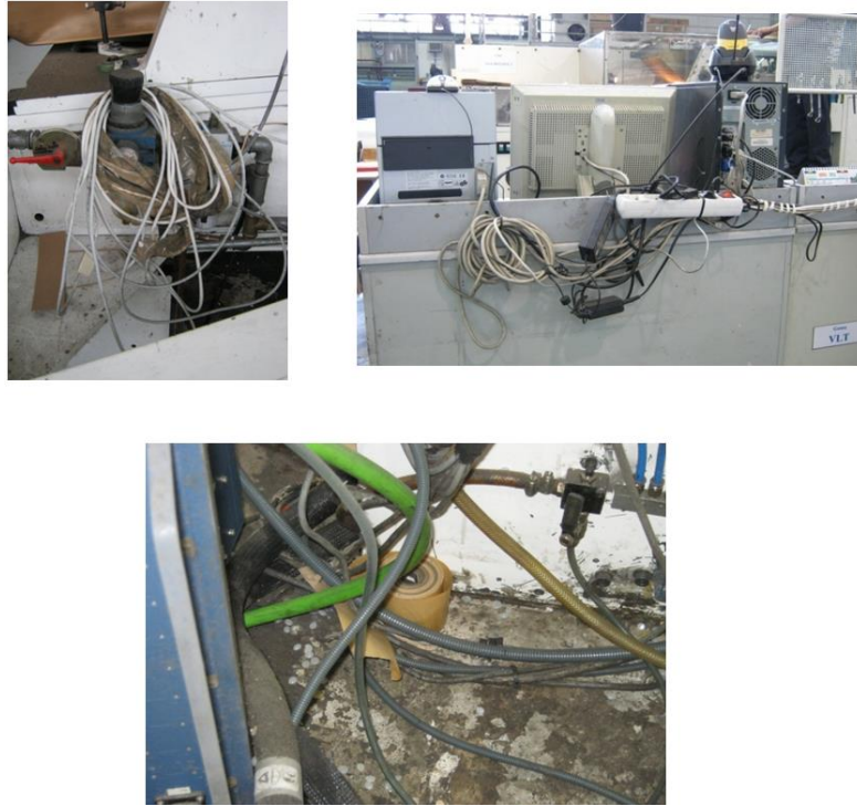
Figura 5.11. Cables mal recogidos
