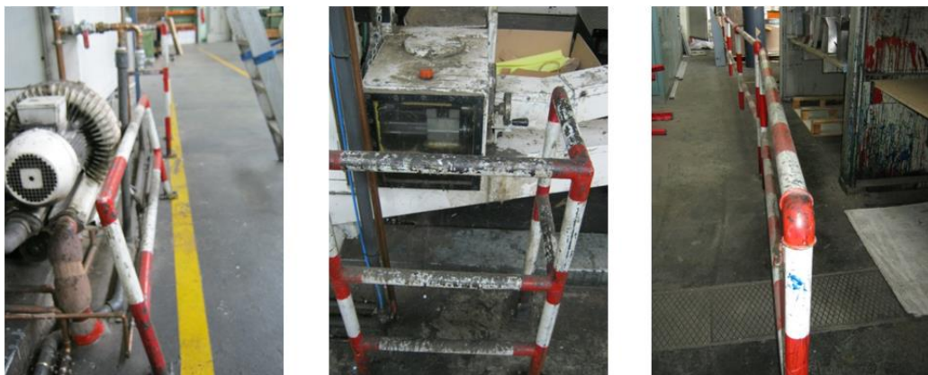
Figura 5.9. Protecciones sucias y en mal estado
