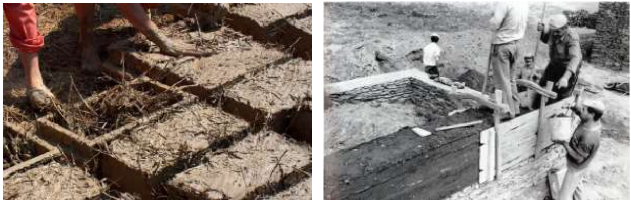
Figura 31: Proceso constructivo de adobes (izq.) y de un muro de tapial (dcha.).
