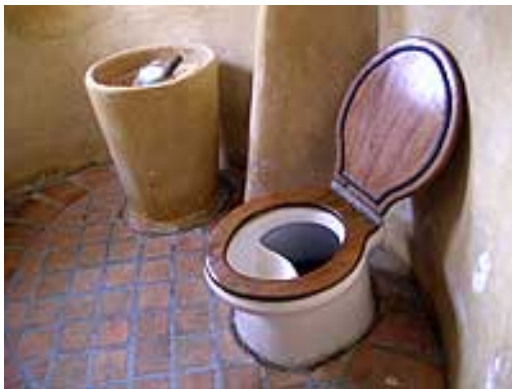
Figura 37: Taza separadora y depósito de material de cubrición de las deposiciones. Fuente: http://bosquedeniebla.com.mx/imagen/fot/172.jpg
