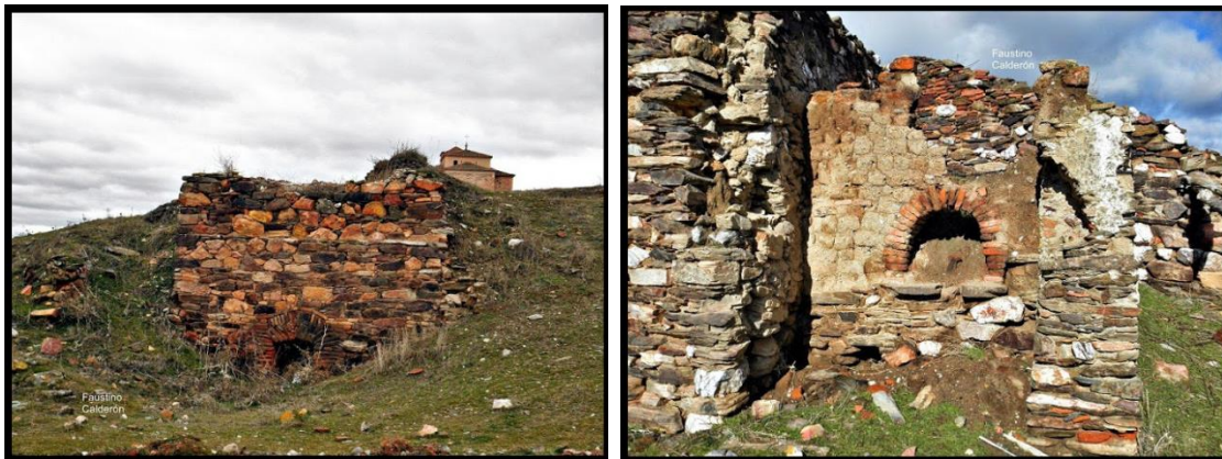
Ilustraciones 2 y 3: A la izquierda horno para hacer cal; y a la derecha horno de pan en el interior de una casa en ruinas.
