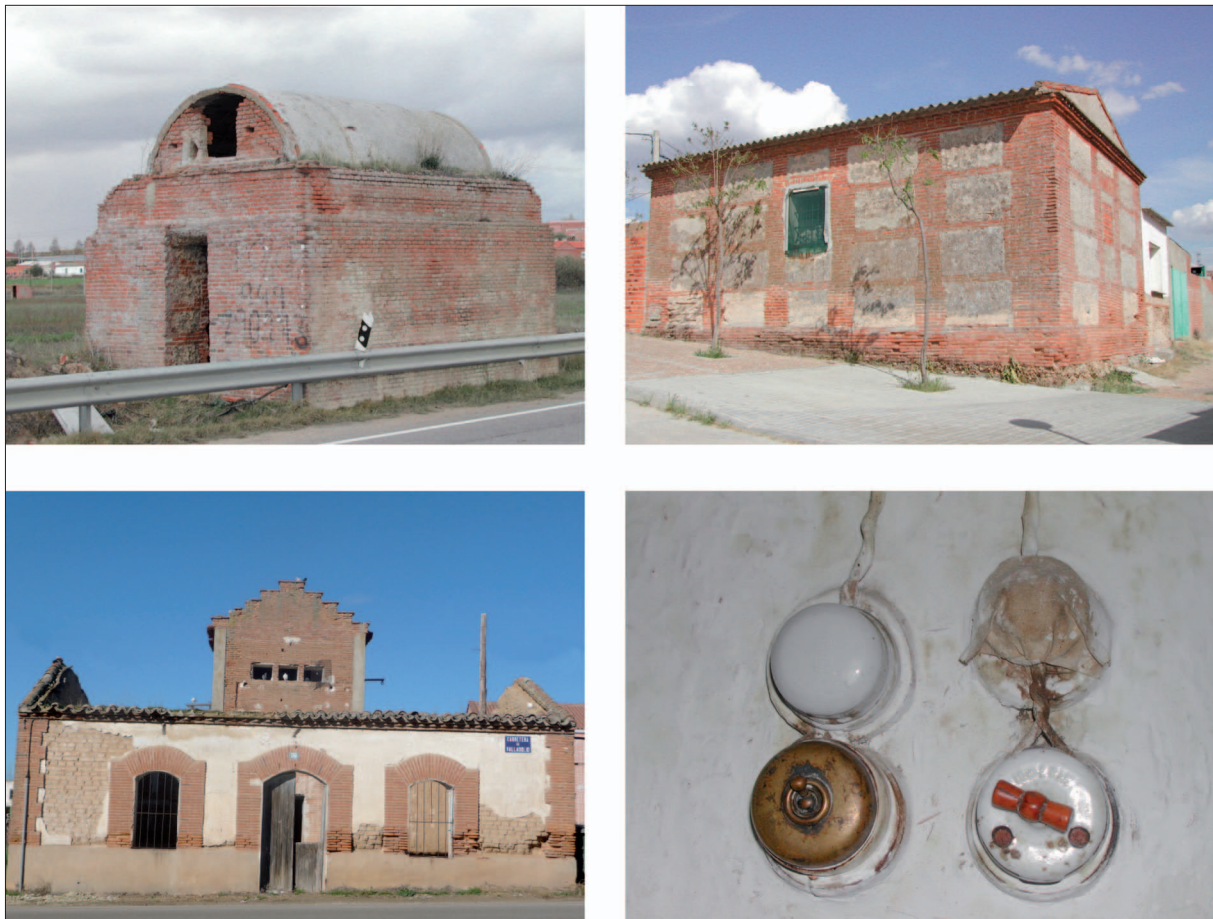
Edificios del depósito del agua y matadero, (imágenes superiores, foto 30/10/2002) y Casa de la Luz y detalle de las primeras instalaciones eléctricas, (abajo, foto 25/01/2014).
