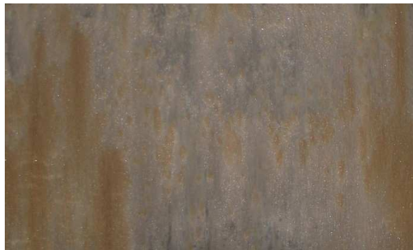
Figura 13. Eflorescencia en el interior de un túnel
