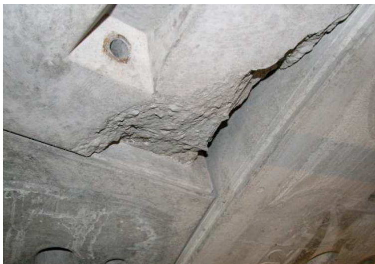
Figura 11. Desprendimiento en una parte de una dovela
