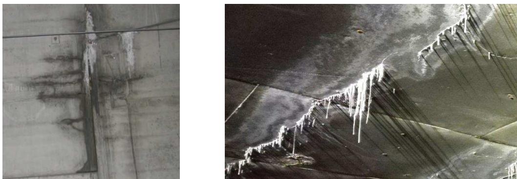
Figura 14. Diversos grados de humedades en el interior de un túnel.
