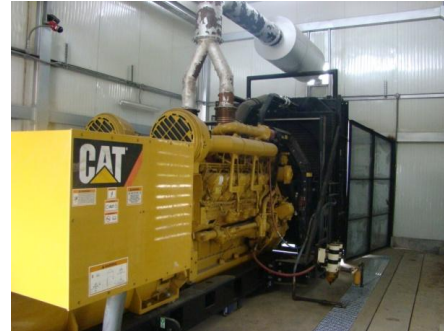
Figura 13. Motor Caterpillar de Central de Generación
