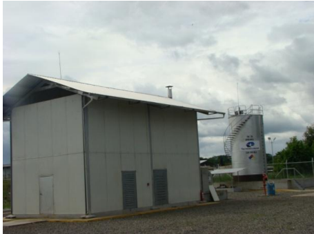
Figura 12. Vista Central Generación de 1 MW de Capacidad
