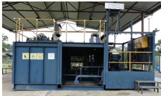
Figura 8. Módulo de recuperación B
