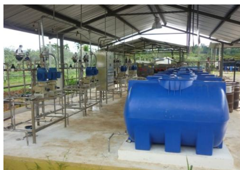
Figura 16. Central de inyección de químicos
