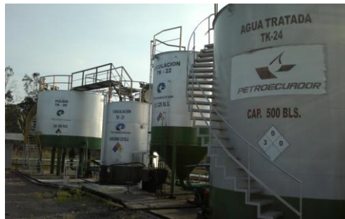
Figura 15. Tanques proceso tratamiento de agua
