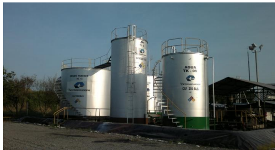
Figura 5. Tanques de almacenamiento de crudo, Jet-A1, agua a tratar y agua de proceso
