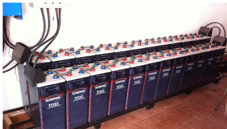
Figura 21: Banco de baterías
