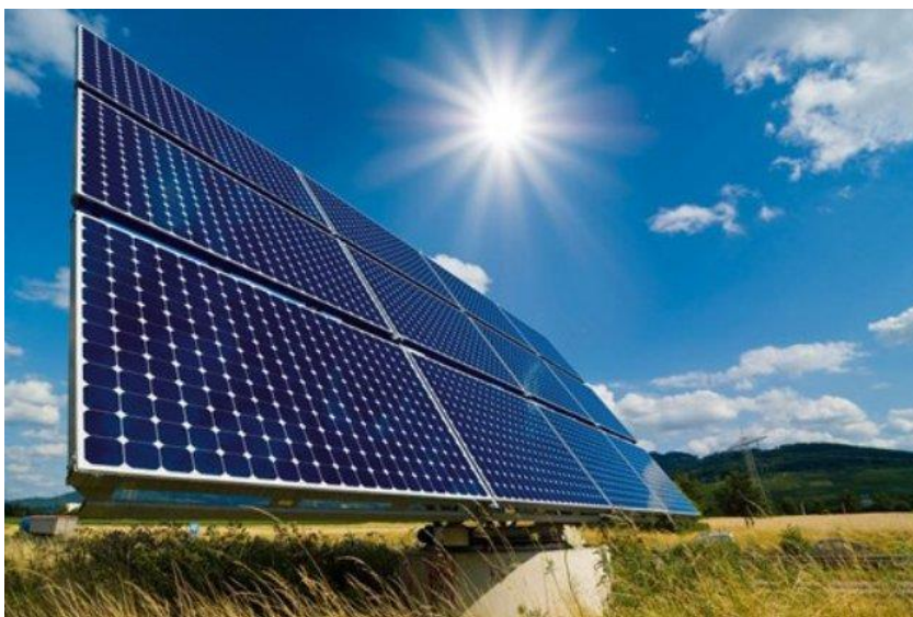
Figura 6: Paneles Solares Fotovoltaicos
