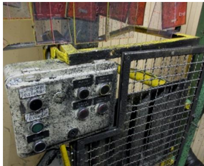
Figura 4.23. Campana de aspiración y botonera antes de las modificaciones
