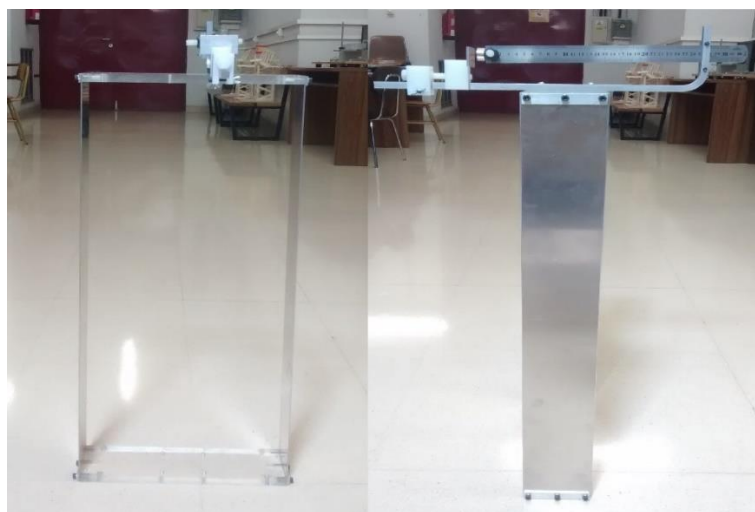
Figura 30. TMD situado en el edificio
