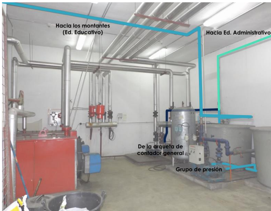
Figura 4.2.3. Sala de calderas, Edificio Docente. (Elaboración propia)
