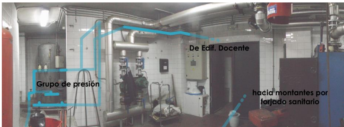
Figura 4.2.5. Sala de calderas, Edificio Administrativo. (Elaboración propia)
