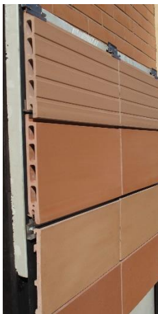
6 Revestimiento exterior de piezas cerámicas
