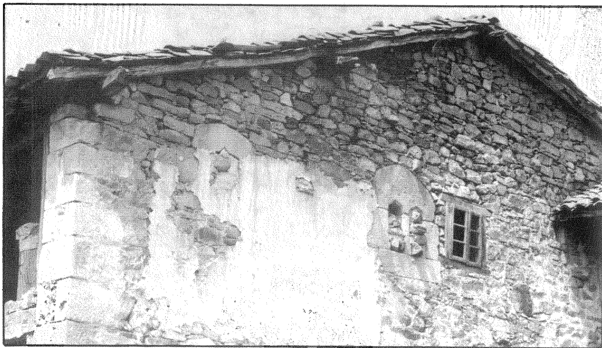
Fachada lateral de construcción con restos de final del gótico. San Felices de Castillería.
