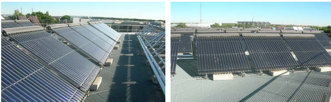
Figura 3.6. Campo solar tubos de calor instalado.
