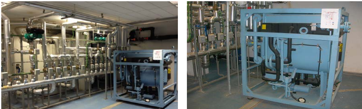
Figura 3.5. Bomba de calor por absorción THERMAX LT1
