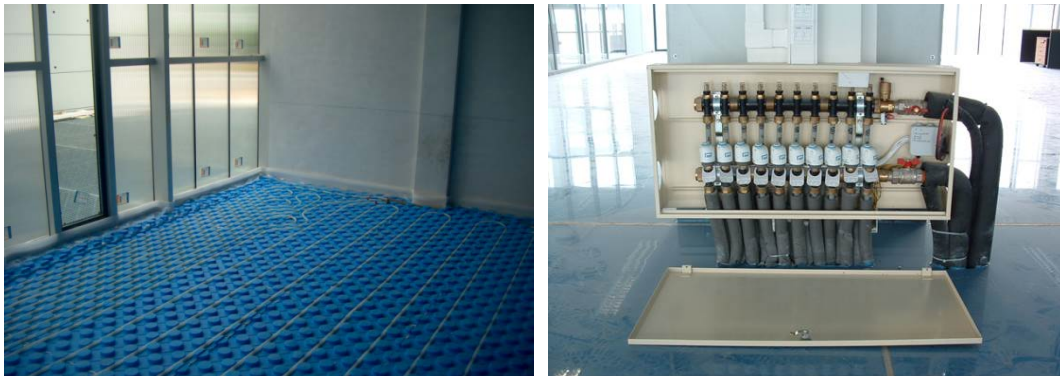
a. Sondas de suelo instalado
