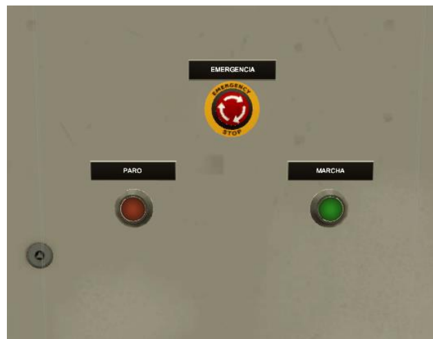
Figura 7.47. Cuadro de mando estación paletizadora
