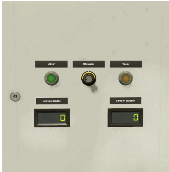
Figura 7.86. Cuadro de mando depósito
