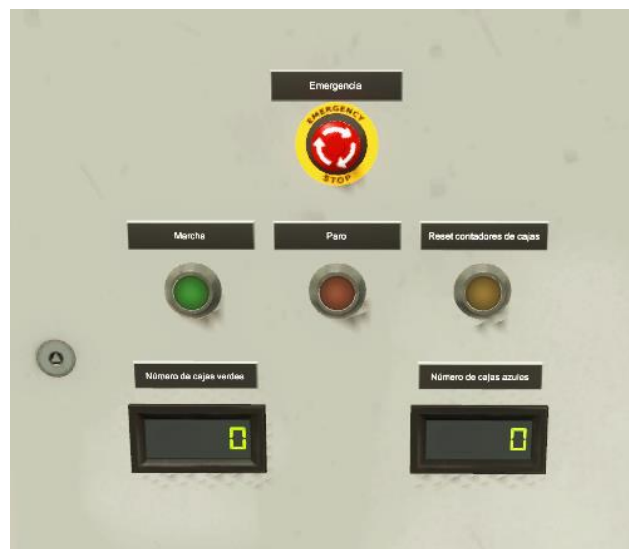
Figura 7.62. Cuadro de mando estación distribuidora
