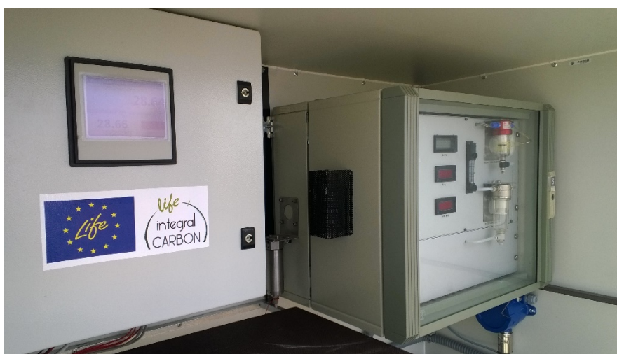
Figura I.27. Cuadro de medida de gases (derecha) junto al cuadro eléctrico principal (izquierda).
