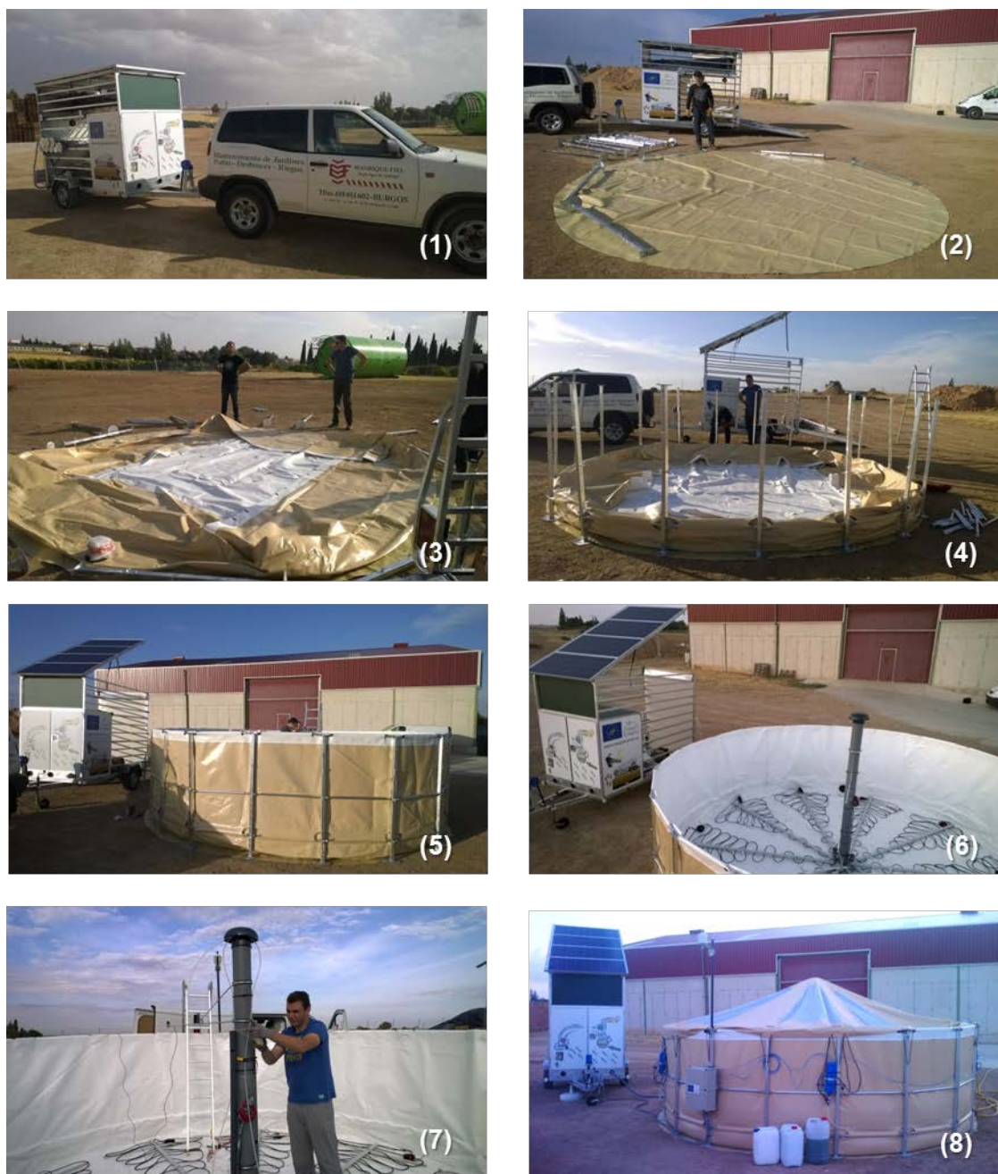
Figura I.32. Secuencia de montaje del MPB. (1) Vista del acople del vehículo tractor al remolque. (2) Tendido de lona de sobre suelo. (3) Despliegue de la membrana del depósito. (4) Montaje de estructura metálica estructural del depósito. (5) Montaje del depósito. (6) Montaje de los brazos porosos. (7) Montaje del mástil para el izado de la cúpula. (8) Finalización del montaje con el MPB listo para ser inoculado.
