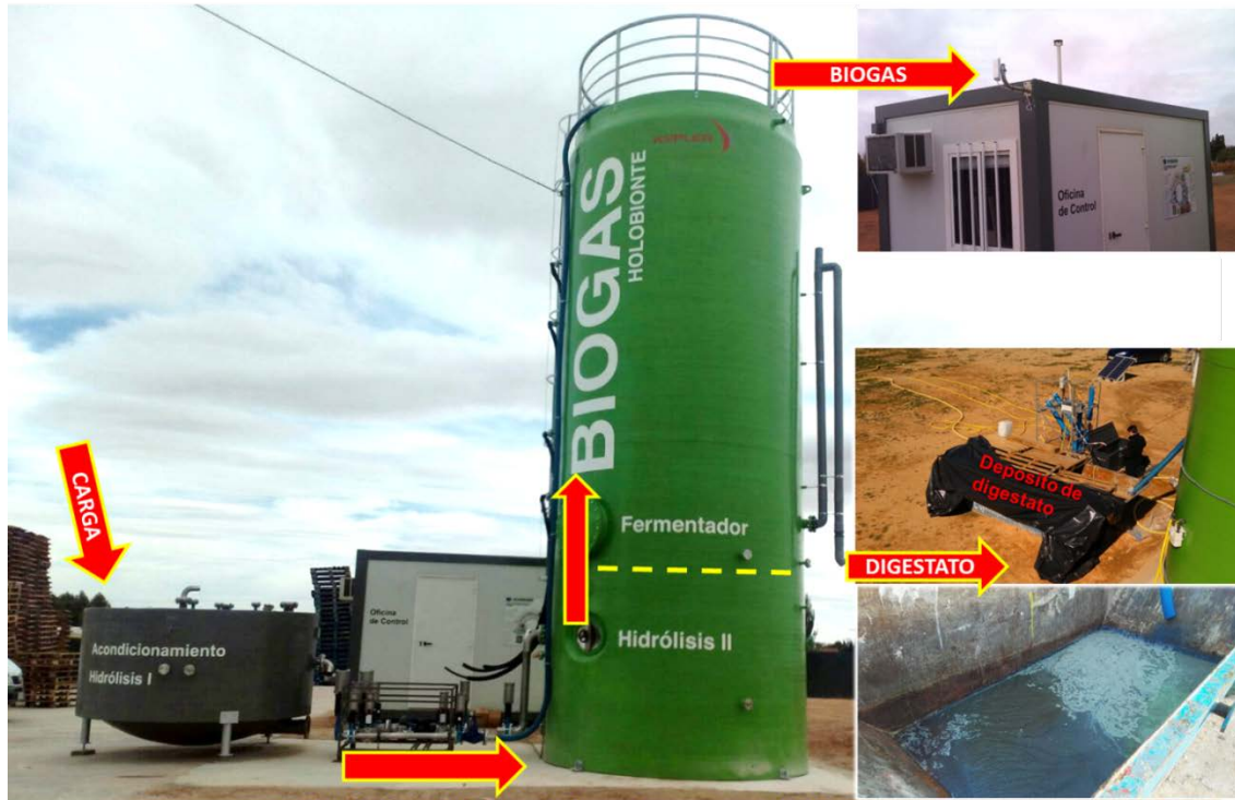
Figura II.45. (1) vista del MDA previa a su funcionamiento. (2) Vista de la caseta donde se localiza aneja la caldera/motor de combustión de biogás. (3) Vista del depósito de digestato de 6 m 3 , y anejo al floculador de digestato. (4) Vista de salida de digestato.
