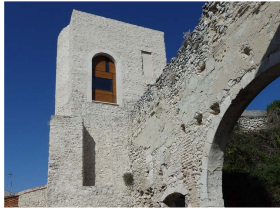
Fig. 5.2.44. Fachada este de la Torre T8 que está junto a la puerta de Santiago [A.S.E. 20/8/2014].
