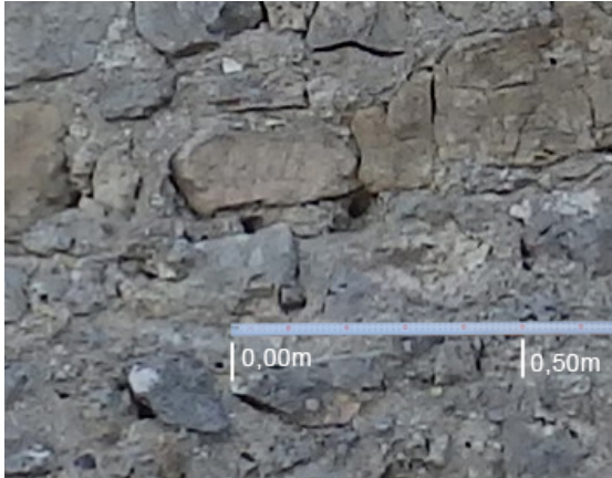
Fig. 5.3.102. Mechinal M5.9 del tramo D2 en T5-T6 donde se ve el uso de varillas pareadas [A.S.E. 17/6/2014]
