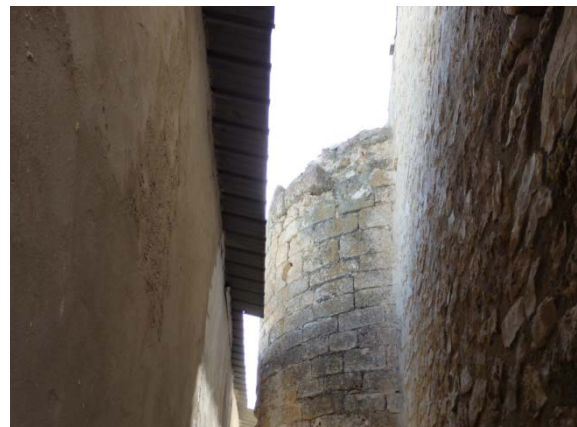
Fig. 1.18. Detalle de la muralla en la calle de la iglesia de Haza, Burgos. Las nuevas construcciones se aproximan demasiado a la muralla. [A.S.E. 29/10/2014]
