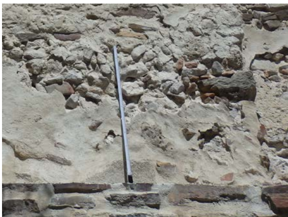
Fig. 5.1.46. Reparaciones en el frente de la base de la torre T1, con aplicación de mortero de cemento [A.S.E. 14/8/2016].
