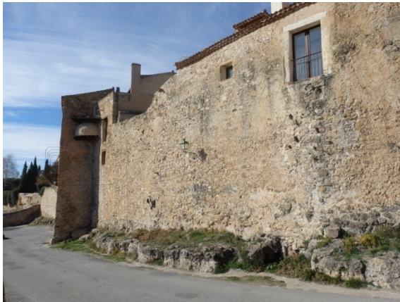
Fig. 5.5.15. Tramo de muralla desde la puerta de la Villa hacia el sur. Se observa el arranque de la muralla, directamente sobre la roca. Al fondo se ve la torre T2 que sobresale del plano del lienzo [A.S.E. 18/11/2015].
