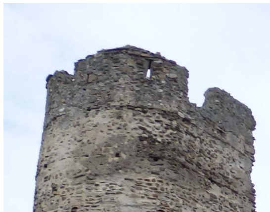
Fig. 5.1.82. Almenas en la torre T3. Se observan varias saeteras en las almenas [A.S.E. 27/4/2015].
