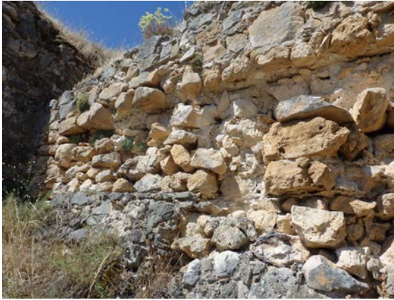
Fig. 5.3.66. Hilada de tapia que ha perdido parte de su material al norte de T12 [A.S.E. 08/07/2015].
