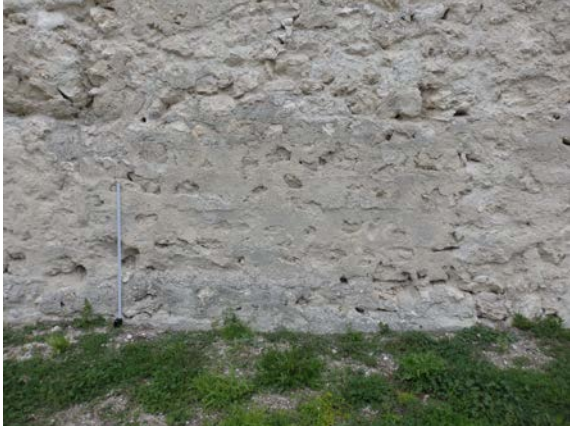
Fig. 5.2.83. Tapia en zona tramo al norte del castillo [A.S.E. 12/5/2016].
