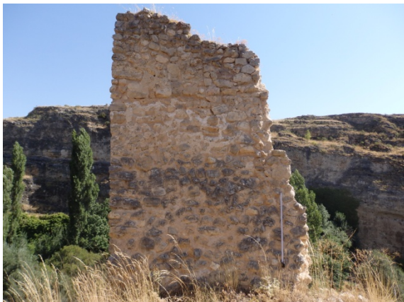
Fig. 5.6.32. Restos del postigo del Vado [A.S.E. 14/8/2016]
