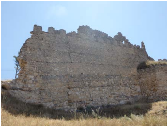
Fig. 5.3.34. Tramo al norte de la torre T5, visto desde el exterior. Se observa una grieta vertical que recorre el muro [A.S.E. 8/7/2015]
