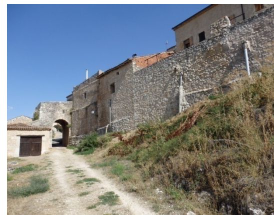
Fig. 5.4.7. Tramo noroeste de la muralla. Al fondo se observa la puerta del Barrio. Las viviendas se apoyan en la muralla y sacan tubos de saneamiento que descienden sobre los lienzos [A.S.E. 3/9/2014].
