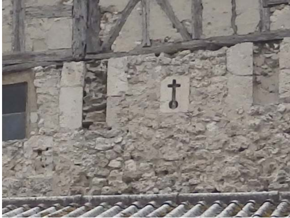
Fig. 5.2.81. Almenas en el tramo P10-P11. A la izquierda es visible una saetera parcialmente oculta en nivel inferior [A.S.E. 12/5/2016]
