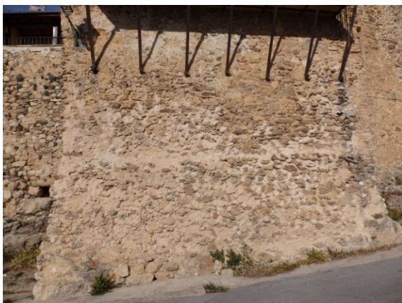
Fig. 5.5.17. Base en forma de talud del frente de la torre T2 [A.S.E. 18/11/2016].
