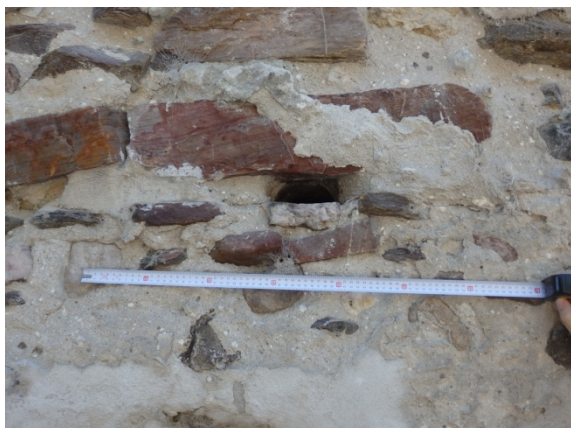
Fig. 5.1.59. Mechinal lateral izquierdo de la tapia T3.10 [A.S.E. 13/8/2016].
