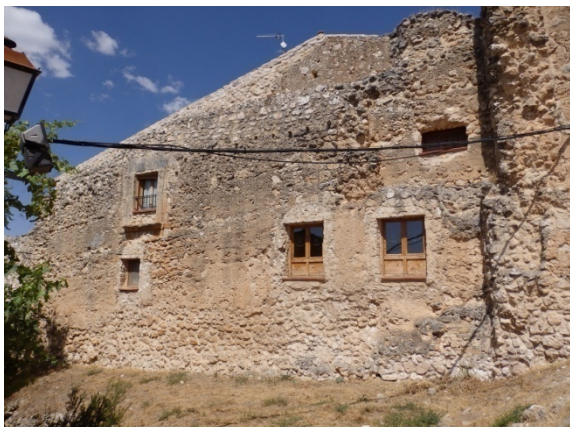
Fig. 5.4.16. Tramo de muralla a la izquierda de la puerta de la Villa (P1-este), vista desde el exterior del recinto [A.S.E. 3/9/2014].
