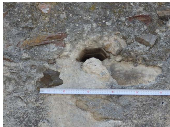
Fig. 5.1.60. Mechinal lateral izquierdo de la tapia T3.8 [A.S.E. 13/8/2016].
