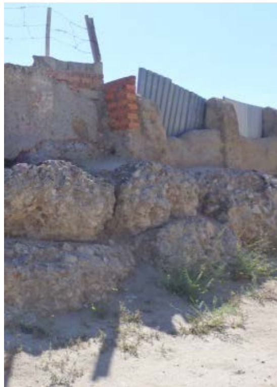
Fig. 1.20. Restos de las tapias de la muralla de Olmedo en estado de abandono. [A.S.E. 01/09/2014].
