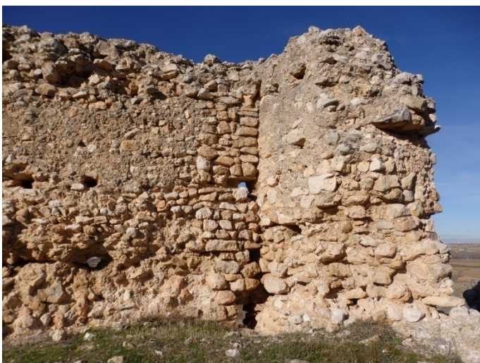
Parte de la torre arruinada
