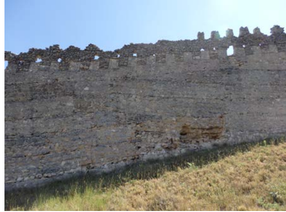
Fig. 5.3.39. Vista de parte del tramo T5-T6, se observa desorden en las tapias [A.S.E. 17/6/2014]
