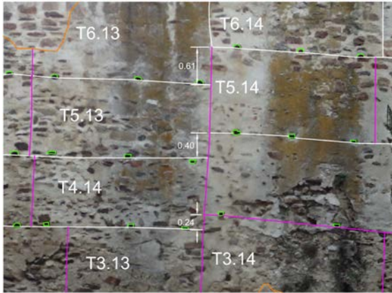
Fig. 5.1.62. Discontinuidad de tramo visible por el salto entre las líneas de mechinales. Desde la izquierda se observa la llegada de mechinales en un nivel, que no se corresponde con el nivel de los mechinales a la derecha.
