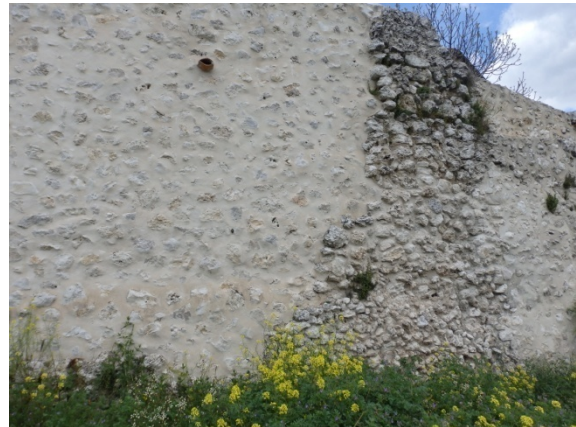
Fig. 5.2.80. Detalle del tramo, donde se observa una zona con diferencia en el acabado [A.S.E. 12/5/2016].
