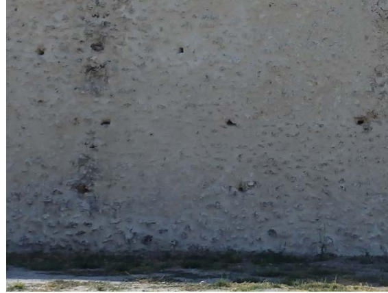
Fig. 5.2.58. Detalle de la base del muro desde el interior. Se pueden ver algunos de los mechinales de las tapias [A.S.E. 20/8/2014].
