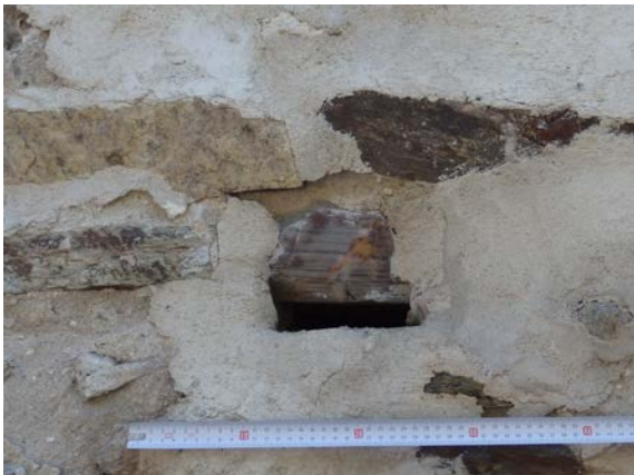
Fig. 5.1.64. Mechinal central de la tapia T3.14. Se observan reparaciones modernas con mortero [A.S.E. 13/8/2016].
