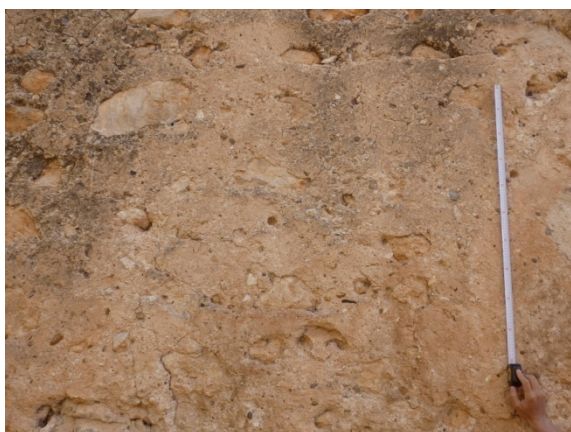
Fig. 5.4.52. Tapia de mampostería en zona P1-T1 [A.S.E. 23/7/2016].
