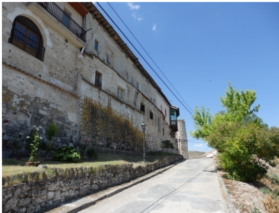
Fig. 5.3.74. Muralla en la zona norte, alterada por las construcciones adosadas [A.S.E. 17/06/2014]
