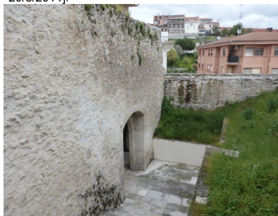
Fig. 5.2.70. Muro perpendicular al lienzo de muralla, a la altura de la puerta de la calle nueva [A.S.E. 20/8/2014].
