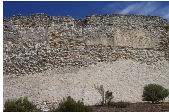
Fig. 5.2.5. Lienzo visto desde el lado exterior. Se observan las reparaciones en la base del muro. Fuente: Fernando Nieto Criado y Jesús Nieto Criado [10/8/2005].
