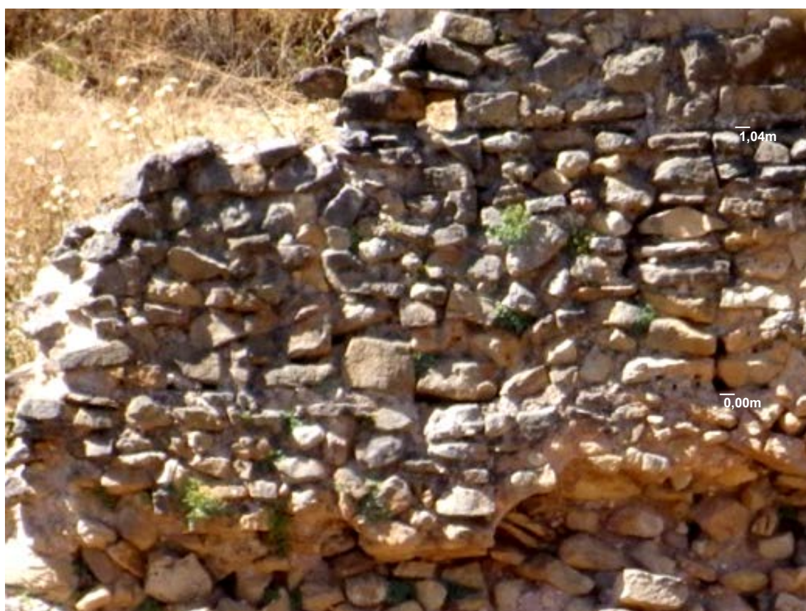
Fig. 5.6.70. Tapia T5.1. A la derecha se observa un murete de piedras planas, que limita la tapia por ese lado. En lo alto, se ve un hueco que podría ser un desagüe, si tenemos en cuenta que está a la altura del suelo del adarve [A.S.E. 23/7/2016]
