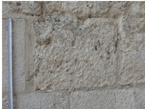
Fig. 5.2.92. Base de sillería en la puerta de San Basilio (P1). A la izquierda y abajo, parte de sillares que parecen más modernos [A.S.E. 12/5/2016].
