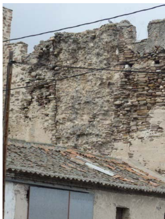
Fig. 5.1.27. Extremo este del tramo, donde se ven marcas en el paramento donde pudo existir una torre adosada (T5) [A.S.E. 11/02/2014].
