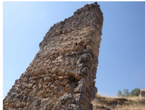
Fig. 5.6.33. Restos del postigo del Vado [A.S.E. 14/8/2016]
