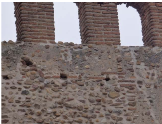
Fig. 5.1.40. Tapia mixta con verdugada sencilla de ladrillo y mechinales con remate de ladrillo [A.S.E. 27/4/2015]
