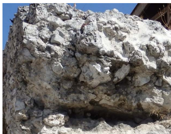
Fig. 5.2.120. Detalle D3, donde se observa el límite entre tapias.
