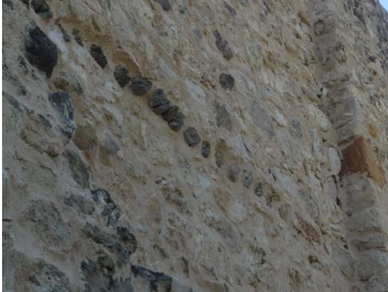
Fig. 5.3.22. Troncos embebidos en el muro del Hospital formando una hilera [A.S.E. 8/7/2015].
