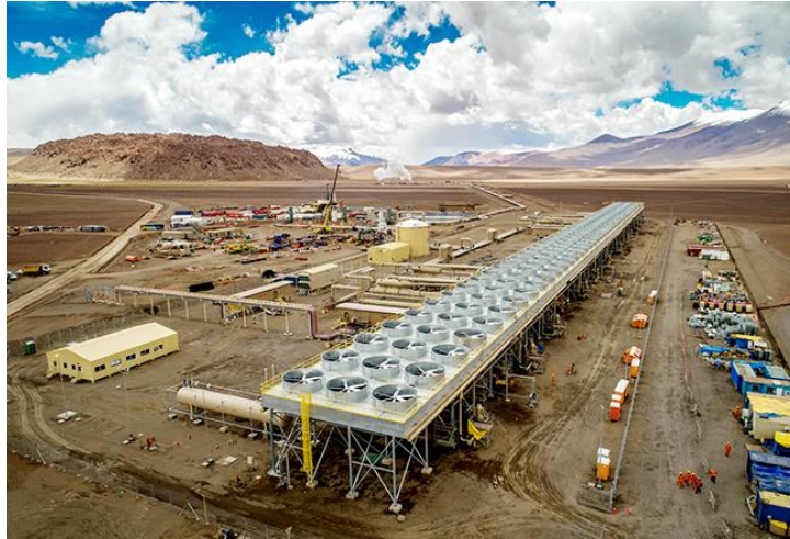
Ilustración 9: Planta Geotérmica Cerro Pabellón, Chile.
