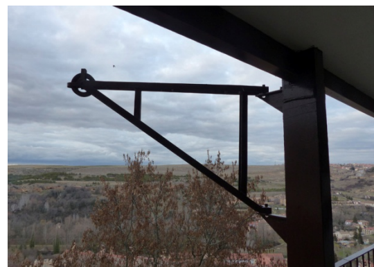
Polea en galerías superiores
