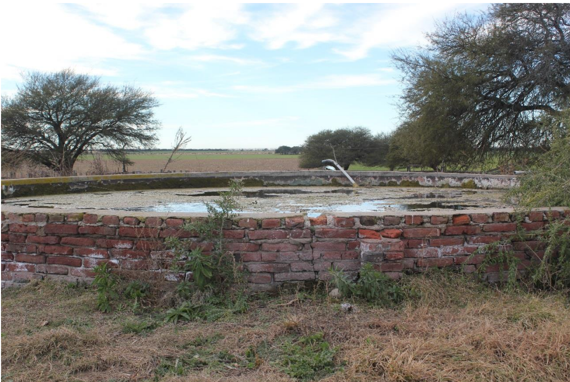
Foto nº 14. Punto de agua. (Fuente: Elaboración propia)
