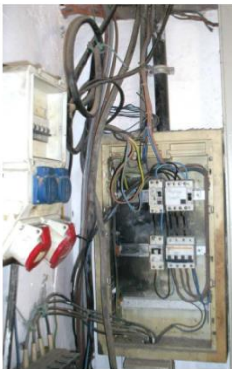
Imagen 5. En rojo se observa el conector desde el que se alimentó el cuadro eléctrico del túnel de pintura. La instalación eléctrica presentaba señales de manipulación indebida y de falta de mantenimiento
