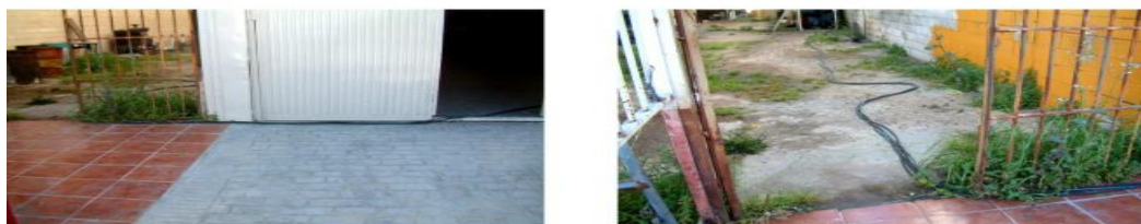
Imagen 3. Los cables unipolares iban por el suelo del exterior de la nave de pintura, hasta conectar con una manguera tripolar enchufada al cuadro principal de la instalación
