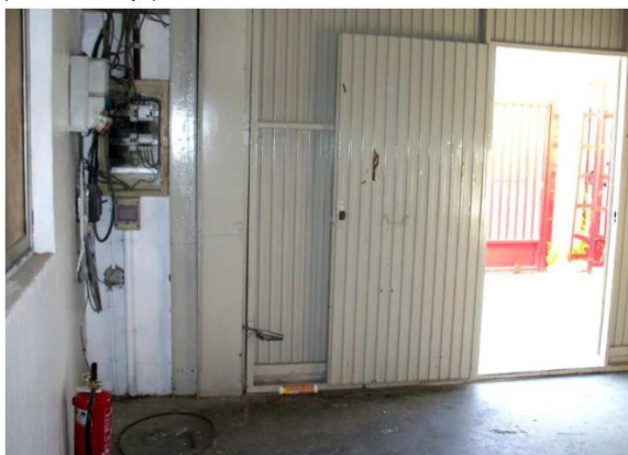
Imagen 6. Lugar donde cayó el trabajador accidentado, junto al cuadro principal del centro de trabajo
