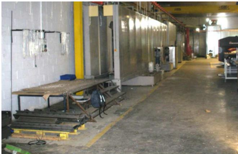
Imagen 1. Túnel de pintura de perfiles, con cuadro eléctrico ubicado al fondo de la imagen
