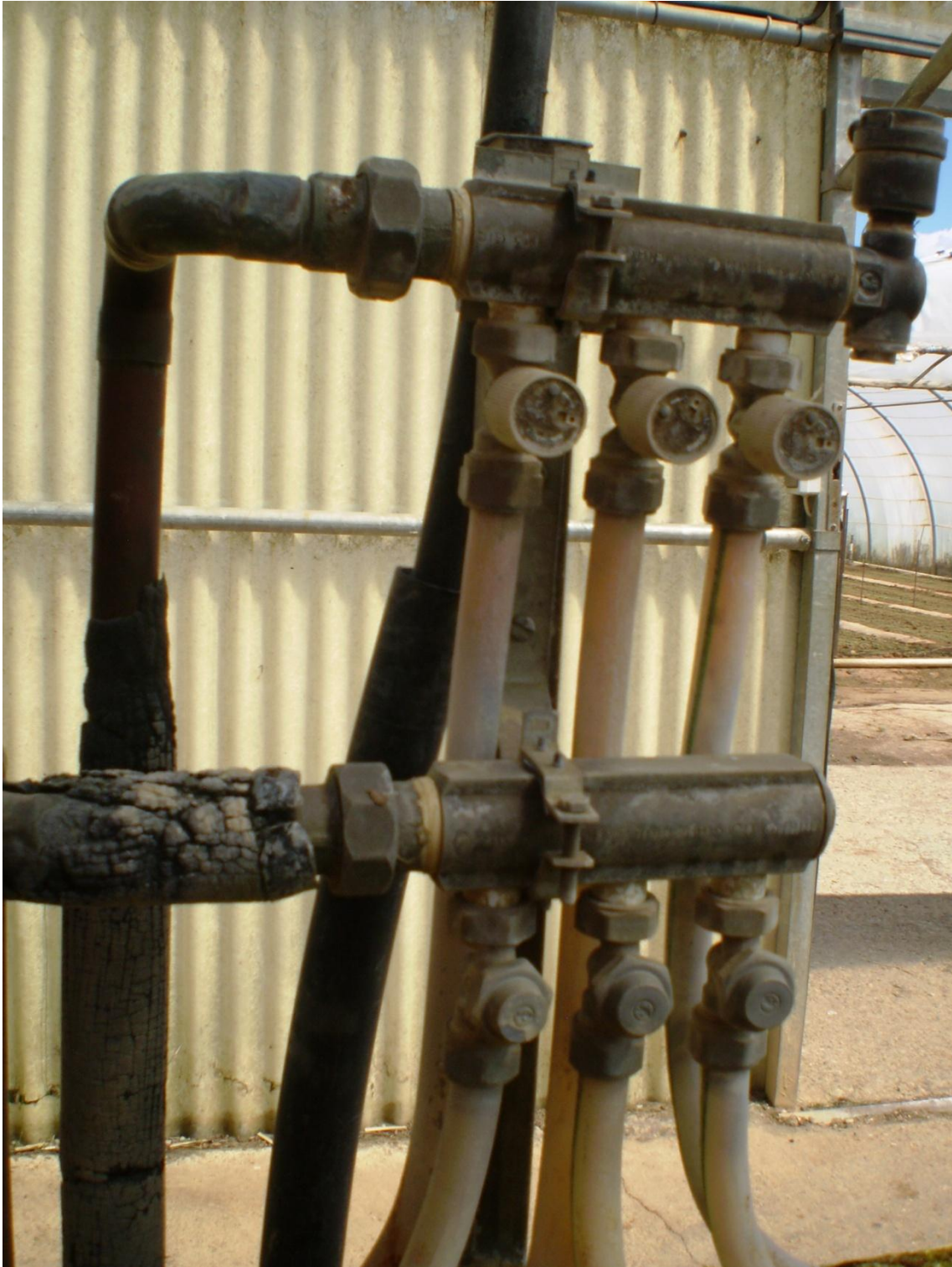
SISTEMA DE SUELO RADIANTE
