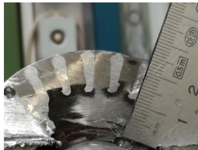
(c) Detalle de un corte de la jaula donde se observa la forma de la barra
